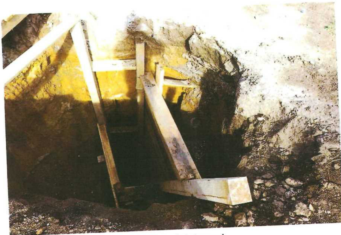
Pohled na zajištěný propad
