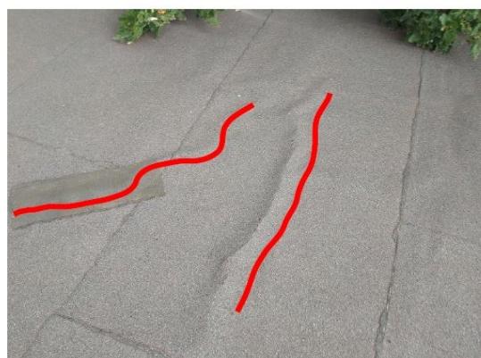
foto /9/ Pohled na degradovaný povrch střechy, zvlněný a popraskaný pás
