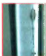
Detail elektrolytické koroze
