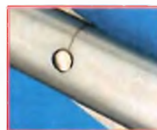
Povrchová trhlinka v závitě spojení
