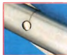
Povrchová trhlinka v závitě spojení
