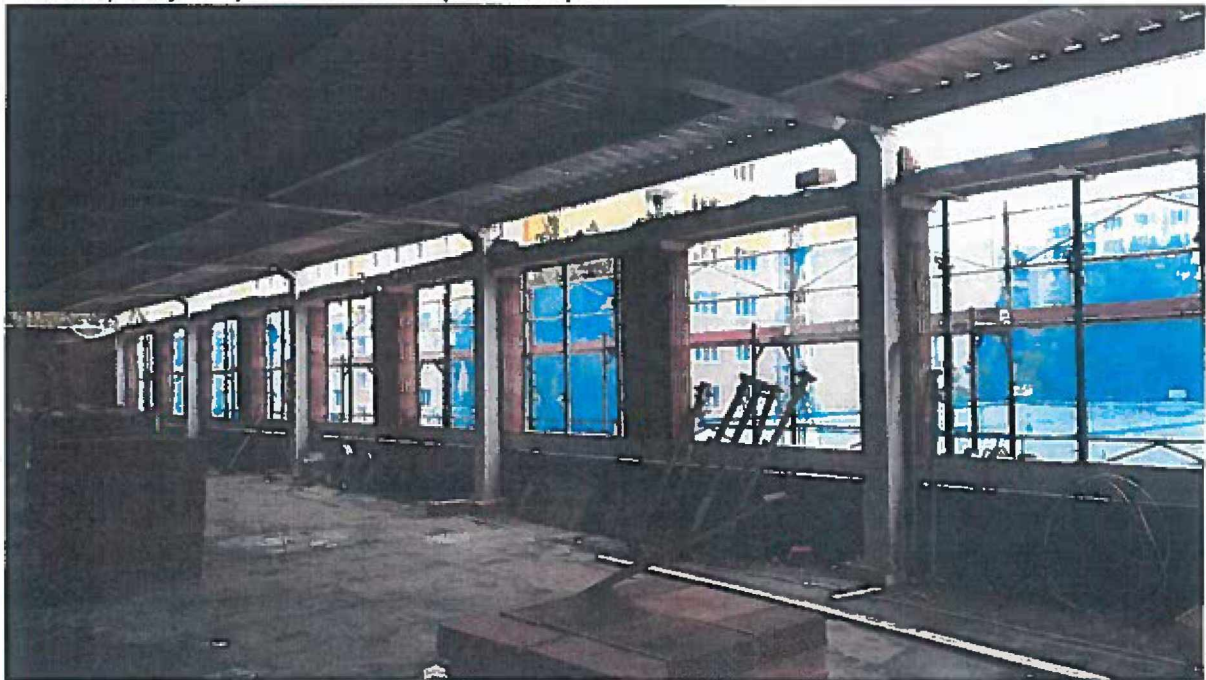
Posunutí ocelových nosníků pro vynesení obvodového zdiva (původně v úrovni podlahy – nyní pod okny) kvůli nosníkům v nové pozici nutno řešit dodatečně jejich odizolování. Pod nosníky proveden ztužující železobetonový věnec na zbytku stávající atiky.
