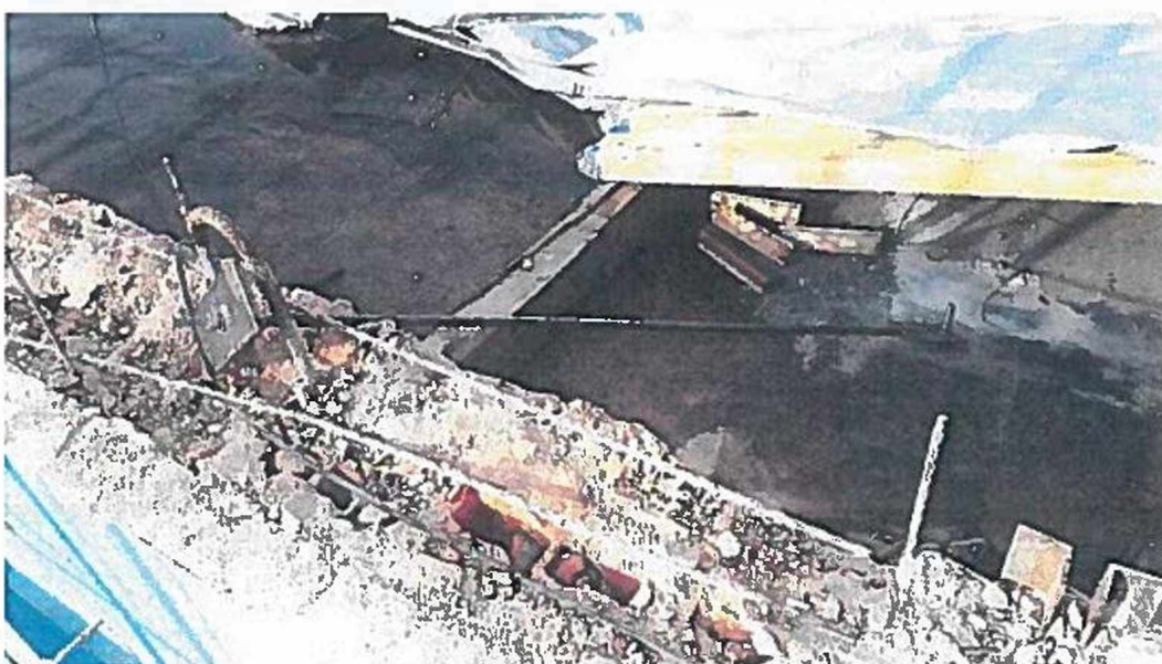
Stav po ubourání stávající atiky před provedením zpevnění věncem.
