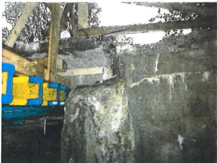
degradace betonu úložného prahu opěry 1
