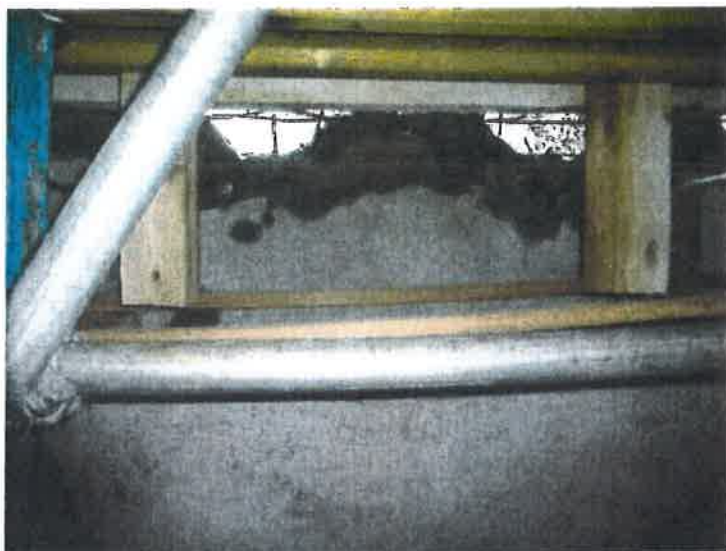
totální degradace betonu kraje konzoly
