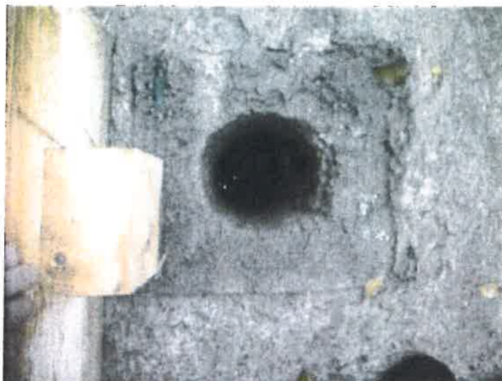
degradace betonu desky v okolí otvoru pro svod odvodňovače
