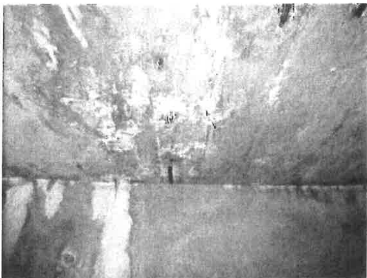
Intenzivní průsaky s výluhy pojiva štěrkovými hnízdy a trhlinami v desce mostovky v před opěrou 1
