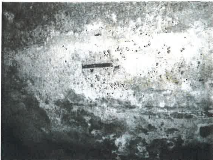
Bodový intenzivní průsak, koroze výztuže, výkvěty
