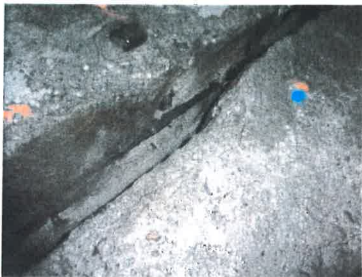
hloubková degradace betonu v hraně desky podél dilatační spáry nad P2
