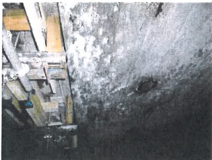
Intenzivní průsaky s výluhy pojiva trhlinami v desce mostovky v okolí spodní hrany
