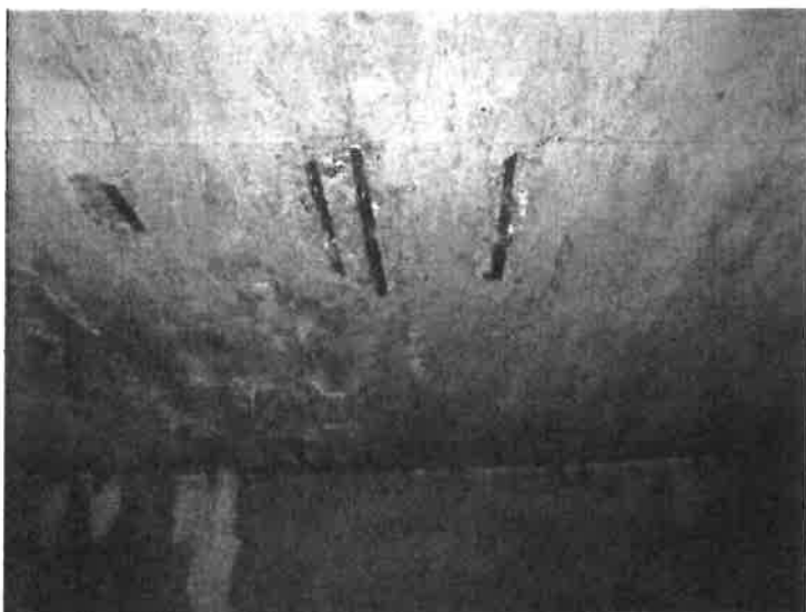
typický stav výztuže - lokálně obnažené silně korodující vložky, v okolních plochách patrná separace krycí vrstvy nad výztuží
