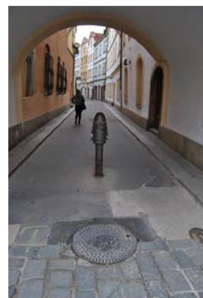
NEVYHOVUJÍCÍ ULIČNÍ POVRCH
