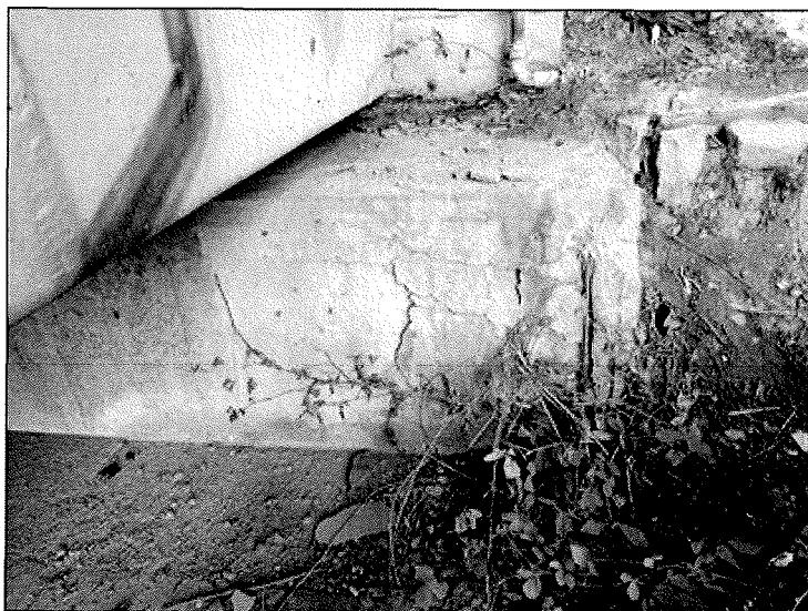
rozpad betonu na levém boku O1
