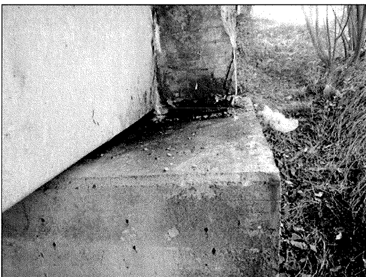
stopy po průsacích na ÚP O4
