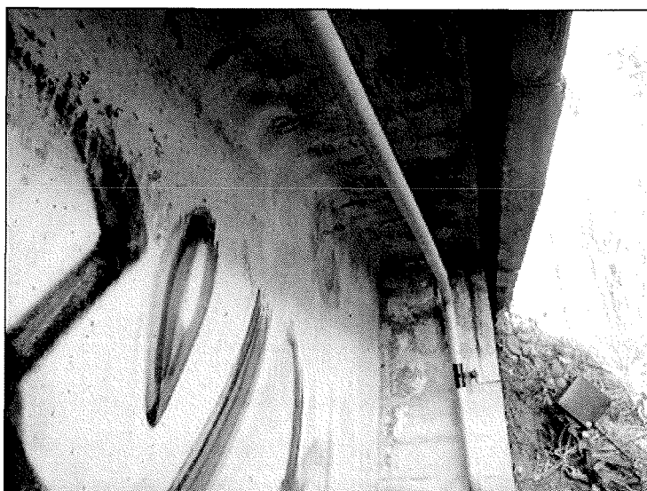
pod levou konzolou je převáděna IS degradace betonu levé konzoly NK
