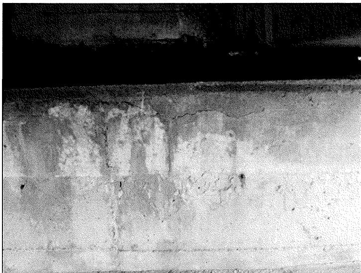
trhliny v hraně ÚP O4 jsou charakteristické pro separaci krycí vrstvy nad korodující výztuží.
