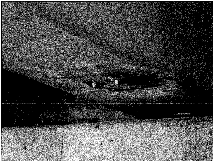
stopy po intenzivních průsacích z nosníku ve 3. poli u O4
