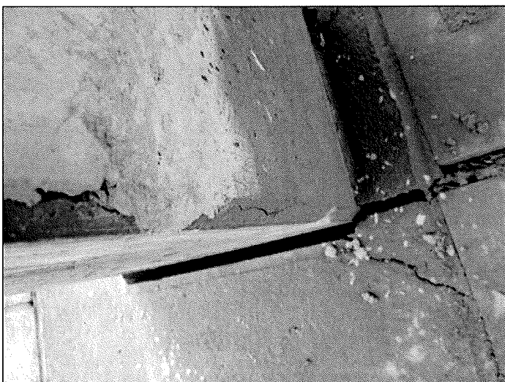
separace krycí vrstvy nad korodující výztuží u vzpěry P3
