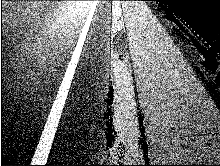
rozpad betonu obruby
