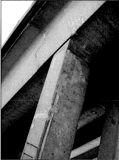
sanace povrchu stojky a boku NK
