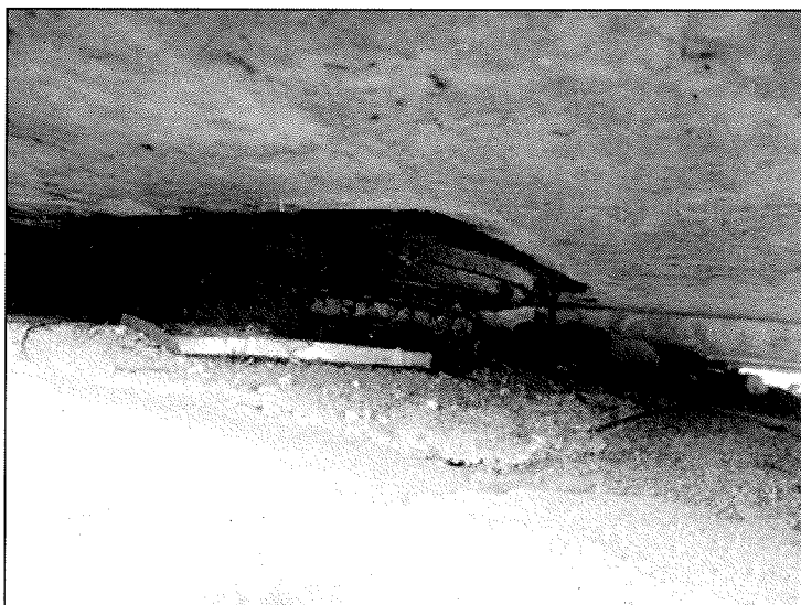
totální koroze ložiska na O1
