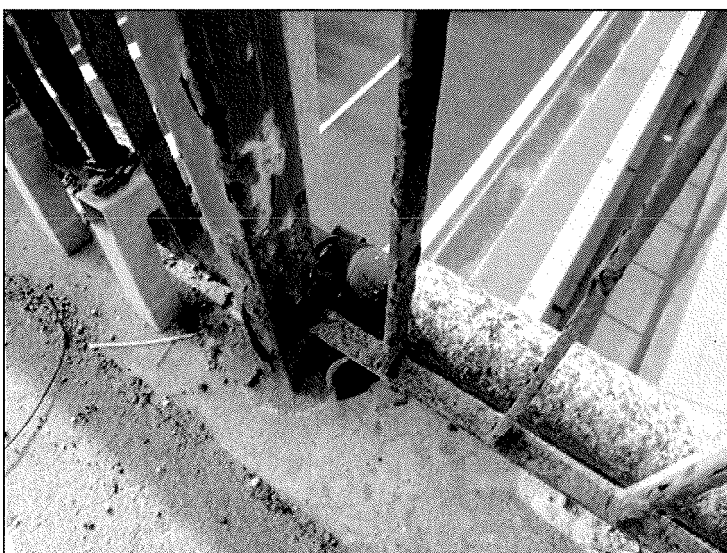
pojistný řetěz háků je kotven ke zrezlému zábradlí
