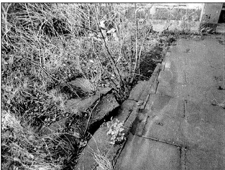
rozpad odvodňovacích skluzů
