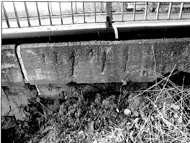
degradace betonu římsy, koroze obnažené výztuže
