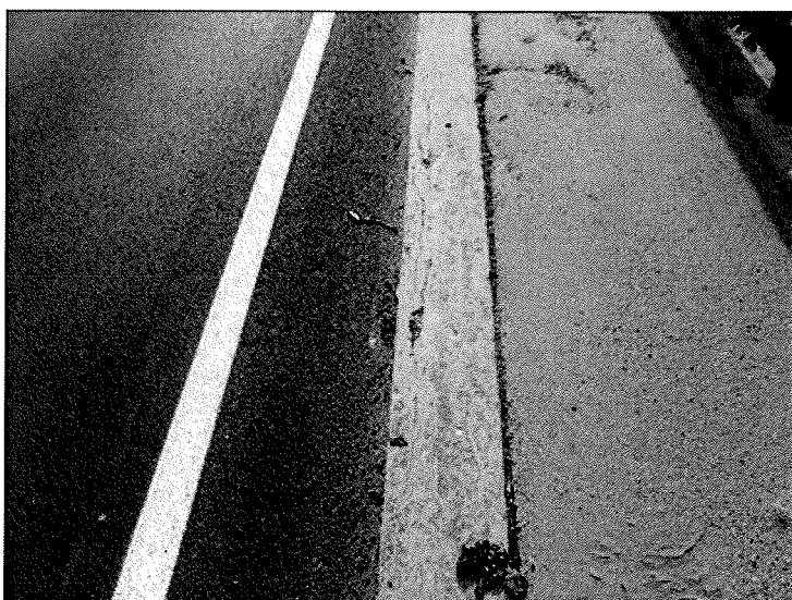
trhliny v obrubě jsou způsobeny mrazovým rozpadem
