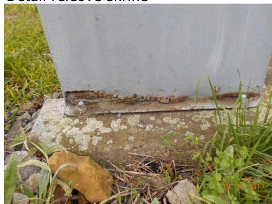
Detail reléové skříně
