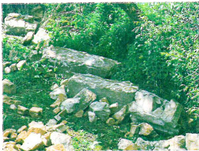
Obrázek 1: samovolný rozpad opěrné stěny
