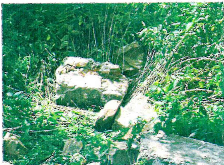
Obrázek 2: zřícené kusy kamenů a betonů do koryta potoka
