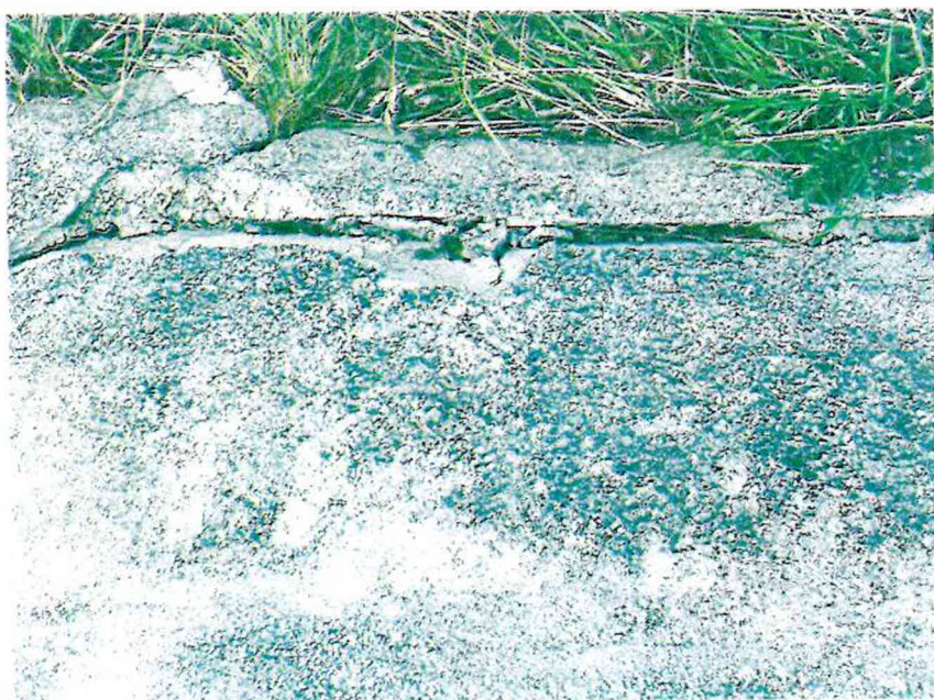
Obrázek 3: praskliny na stávající opěrné stěně, která je umístěná v těsné blízkosti nemovitosti č.p. 86, 128
