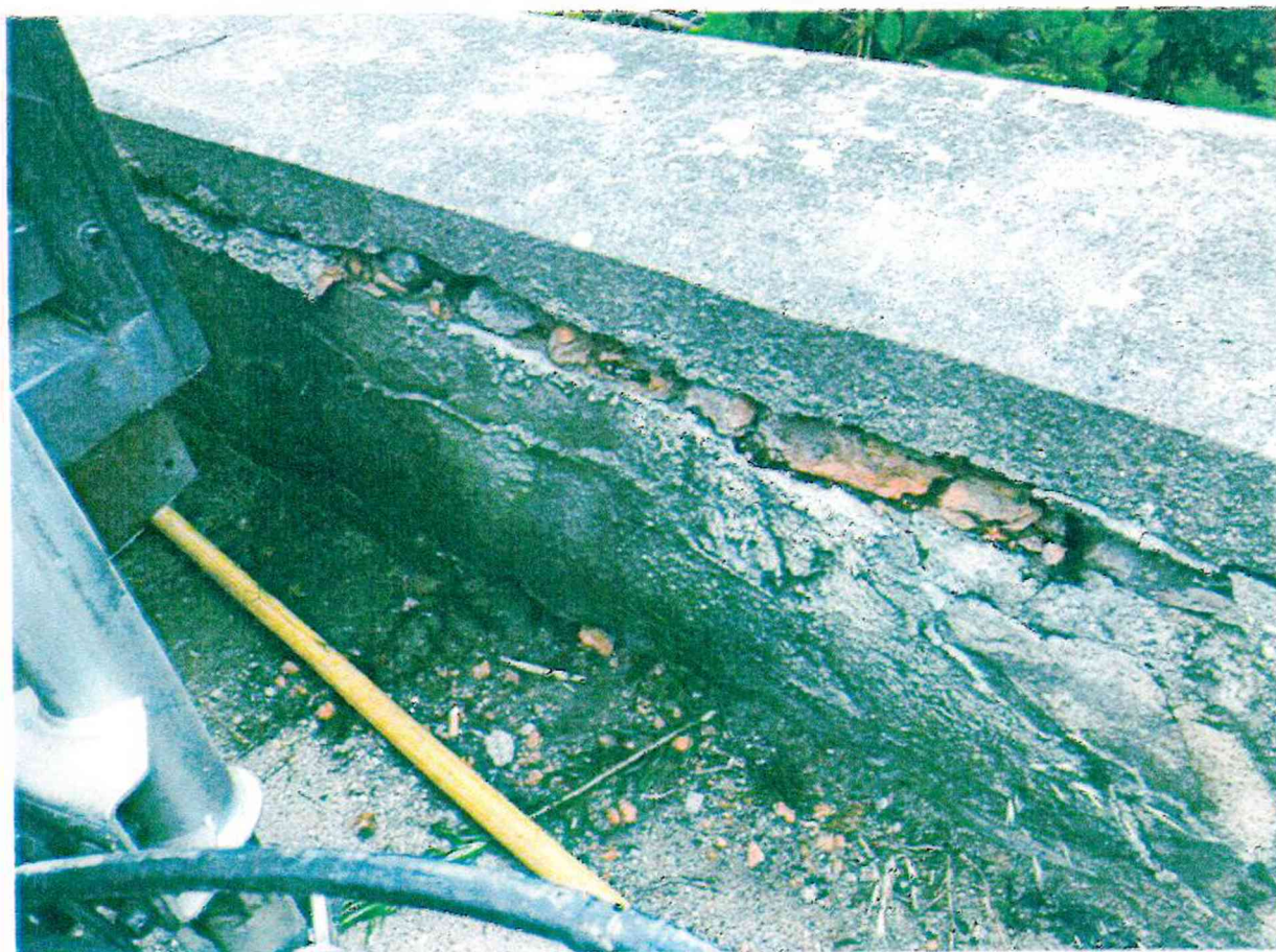
Obrázek 8: jednoznačně viditelně odpadávání úlomků při provádění prací
