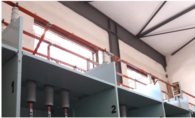
Obr. č.2. – Nepřístupná okna v rozvodně 22kw z prostoru rozvodny
