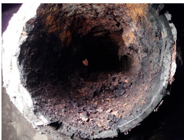
Obr. č.5 – Zanešené potrubí venkovní části kanalizace
