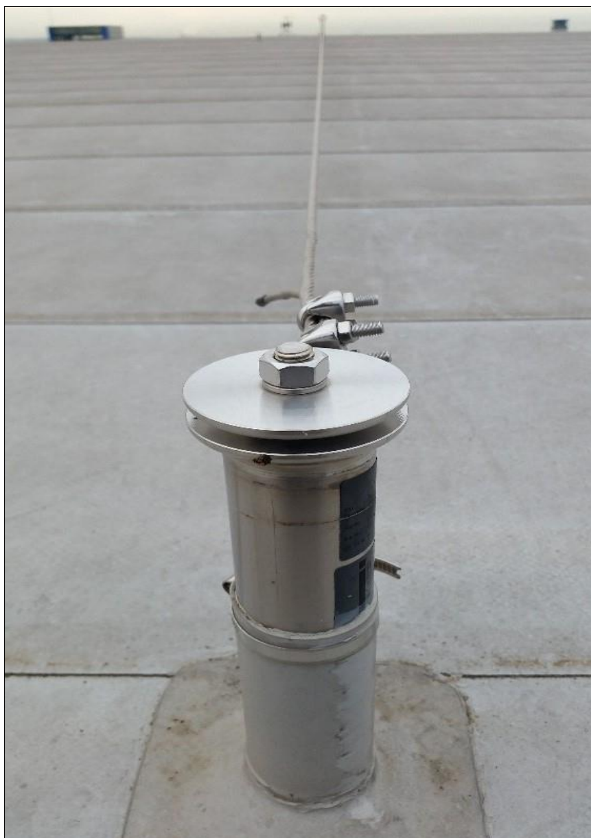
Obr. 9 - Kotvící bod lana záchranného systému na parkingu C
