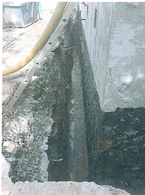
poškozená dešťová kanalizace
