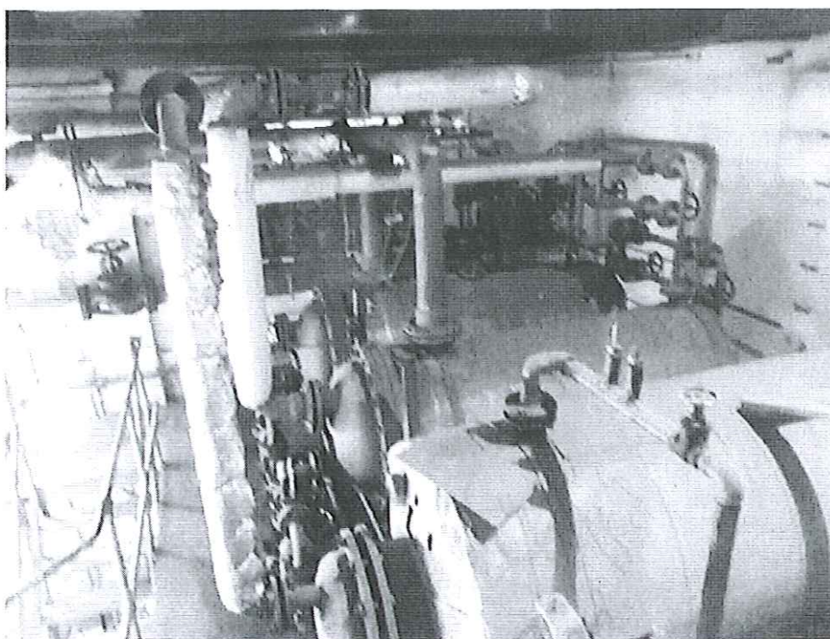
Výměníky tepla a ohříváč vody
