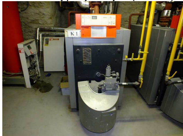
Jeden z kotlů Viessmann sloužící pro vytápění a ohřev TV (7. 12. 2015)
