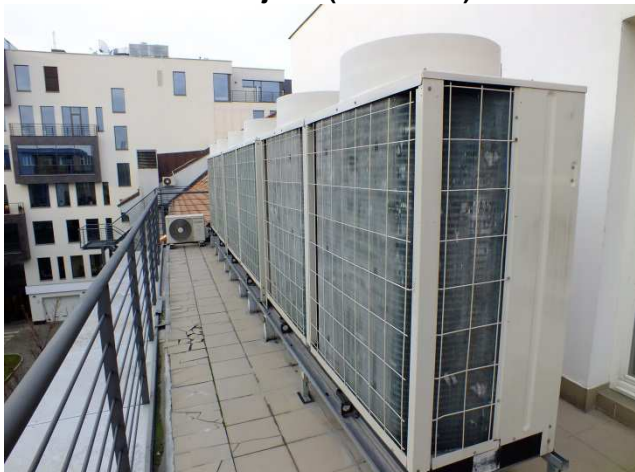
Kondenzátorové jednotky VRV systému (7. 12. 2015)
