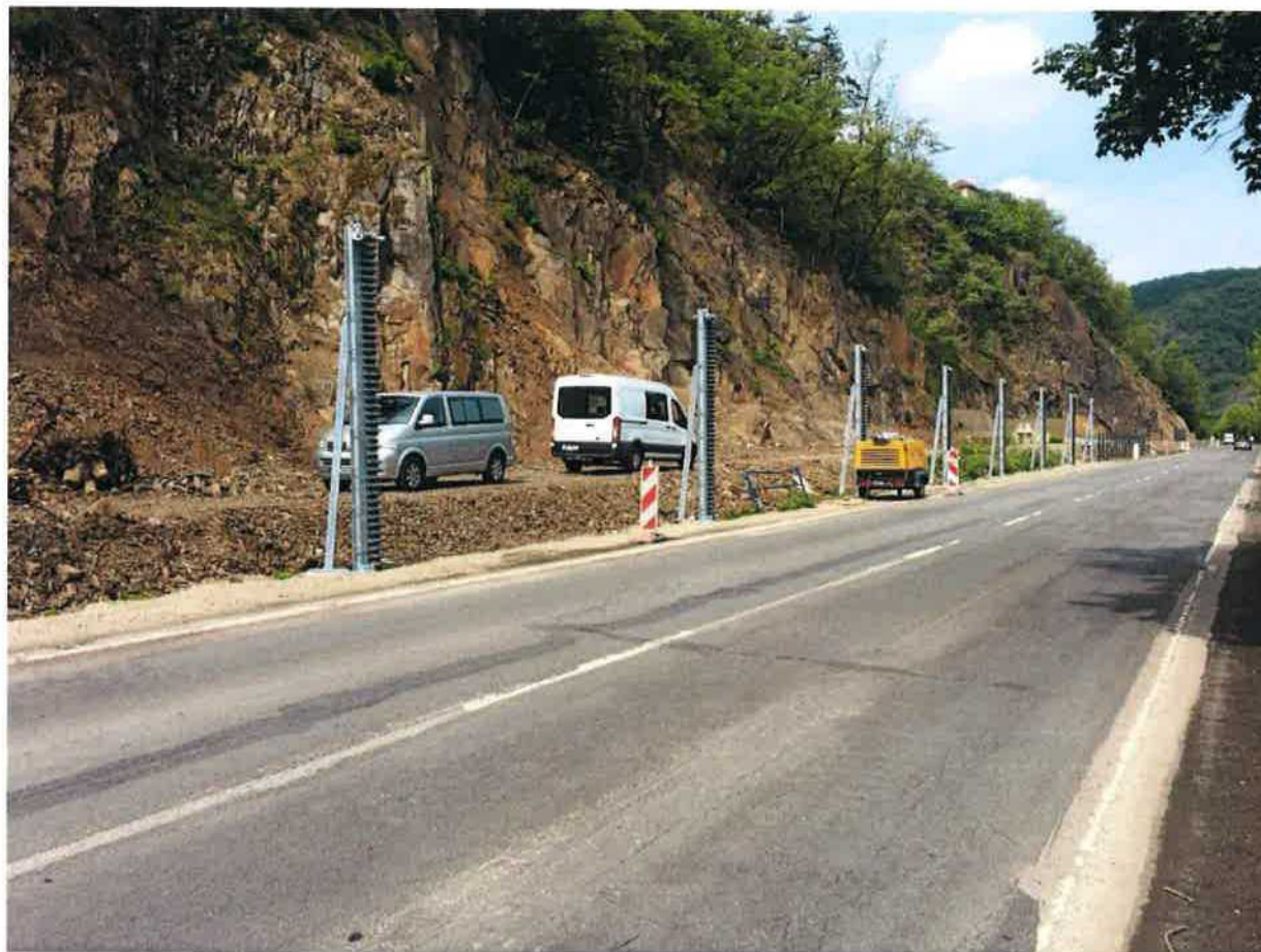
foto 5, SO 105, dynamická bariéra, květen 2018
