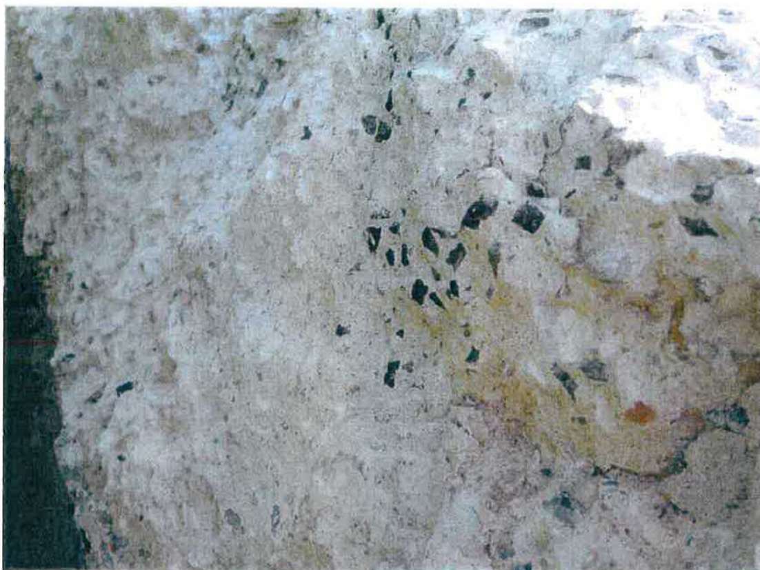
DTTO - detail degradace betonu
