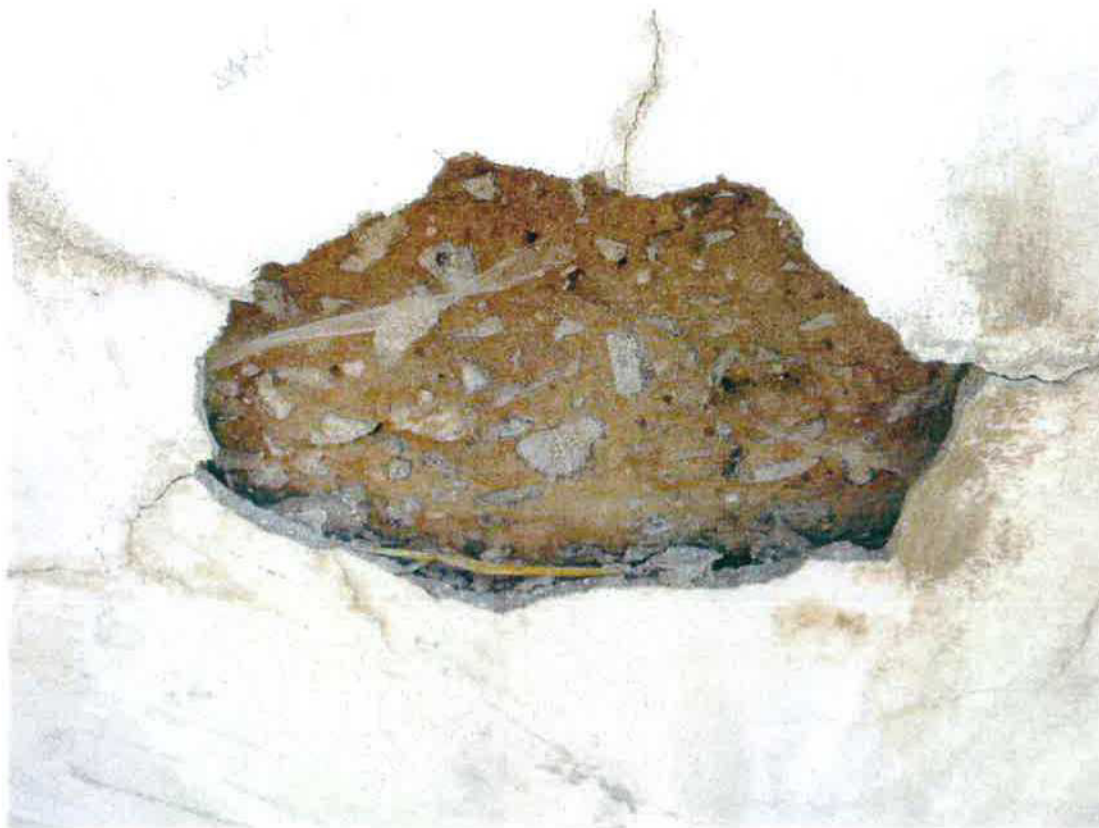
DTTO – separace ochranných omítek od rozpadajícího se podkladu (betonu zdi)
