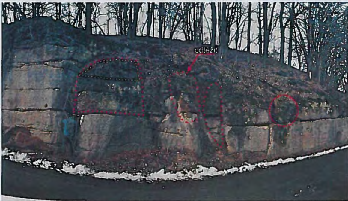
Foto 7: Čelní pohled na labilní skalní objekty napravo od místa řícení. Objekt vlevo je oddělen od masivu puklinou probíhající kose k linii zářezu. Tato puklina je ukloněná proti svahu, což je stabilitně nepříznivé vůči svahovému pohybu odvalení překlopením. Riziková část je zvýrazněna tečkovaným polygonem . Svrchní partii je možné odlehčit a skalnímu objektu tak odlehčit. Česká geologická služba doporučuje objekt monitorovat. Červená šipka s popisem odlehčit ukazuje na nejméně stabilní skalní objekt, u něhož dojde k odvalovému řícení. Napravo od tohoto objektu se nachází partie, kterou je možné stabilizovat zednickými pracemi. V červené tečkované kružnici je zvýrazněn samostatný skalní blok (detail viz foto 9 a 10), který ČGS doporučuje neodtěžovat a stabilizovat jej vyzdáním otevřených puklin.
