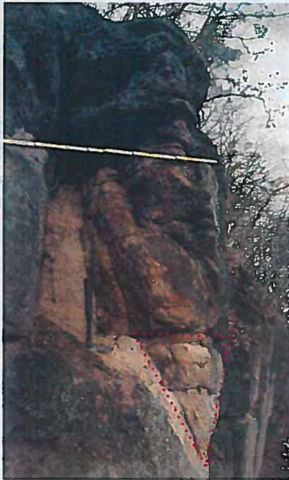
Foto 8: Červeně tečkovaný trojúhelník zvýrazňuje skalní klín, o který se opírá labilní skalní objekt zcela oddělený od masivu.
