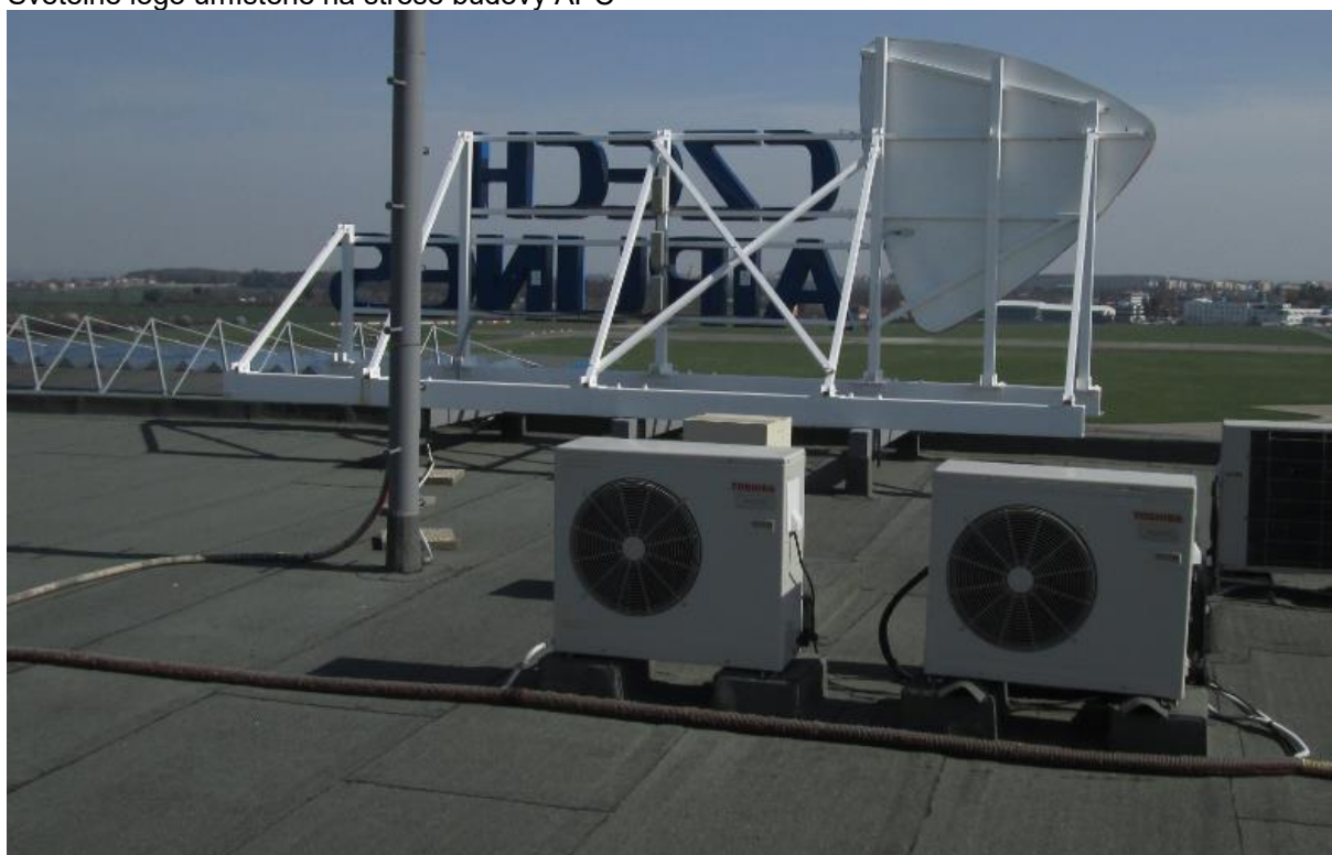
Světelné logo umístěné na střeše budovy APC
