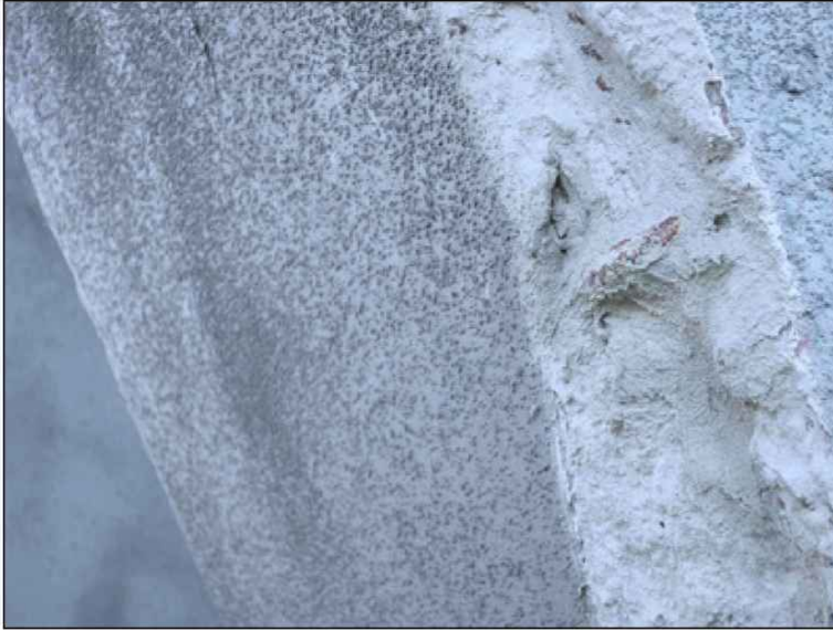
nekvalitně provedená sanace vzpěry P3
