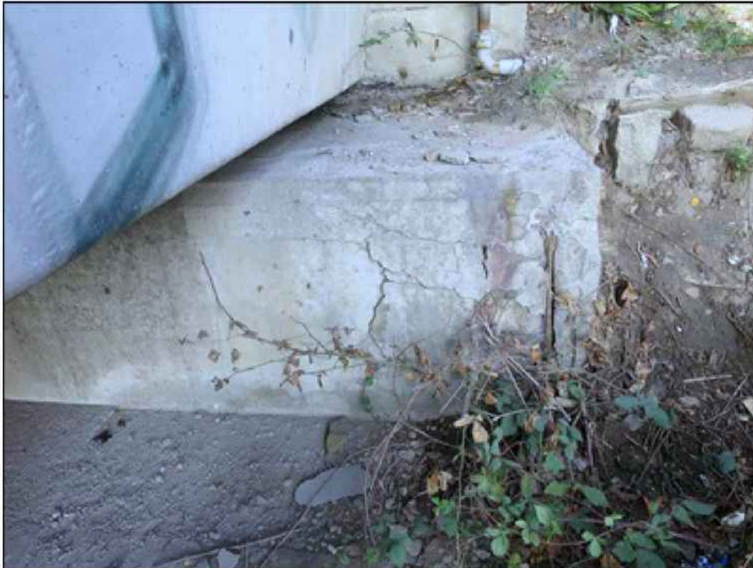
rozpad betonu na levém boku O1
