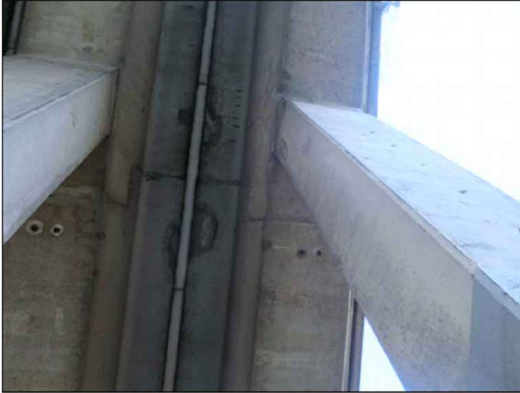
stopy po průsacích mezi nosníky
