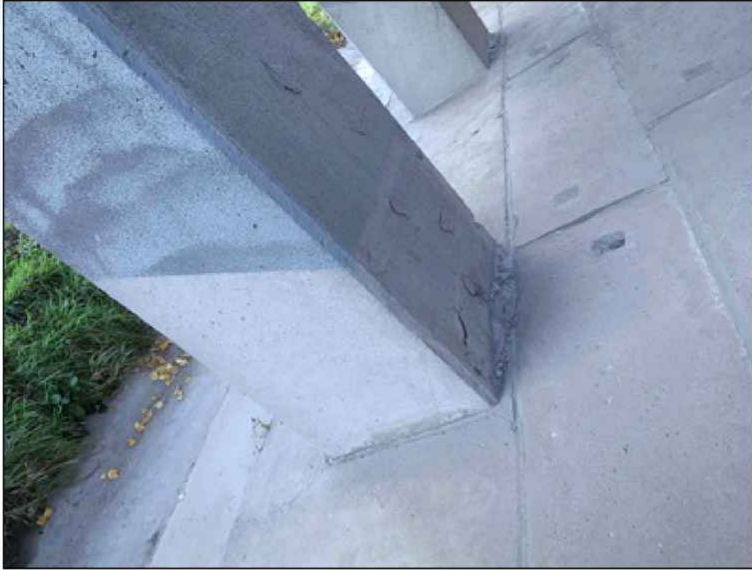
separace krycí vrstvy nad korodující výztuží u vzpěry P2
