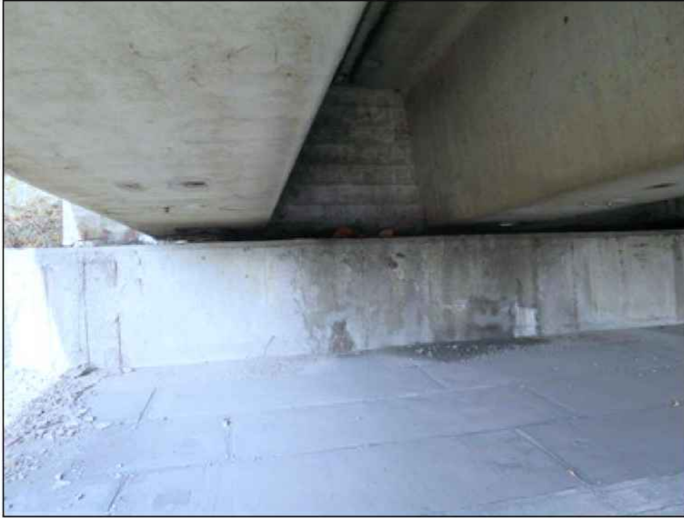
stopy po průsacích na lici O1
