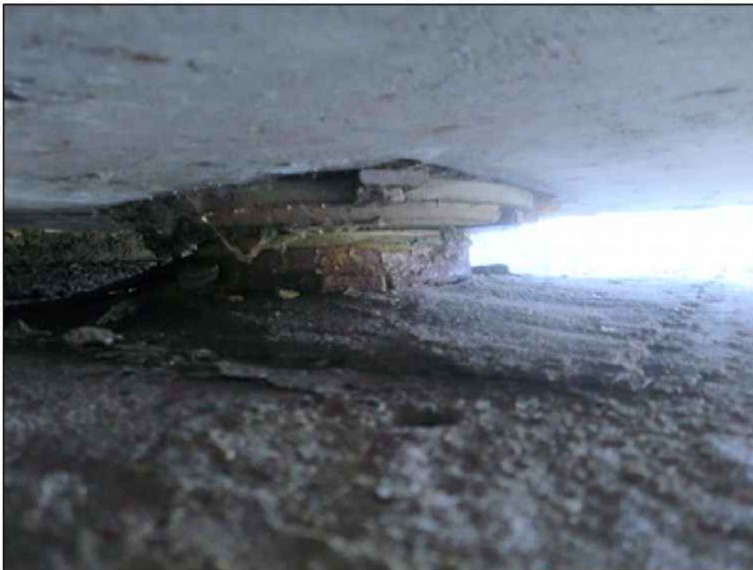
totální koroze ložiska
