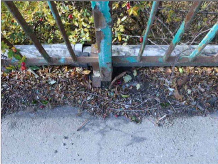
totální koroze sloupku zábradlí v místě kotvení do řimsy
