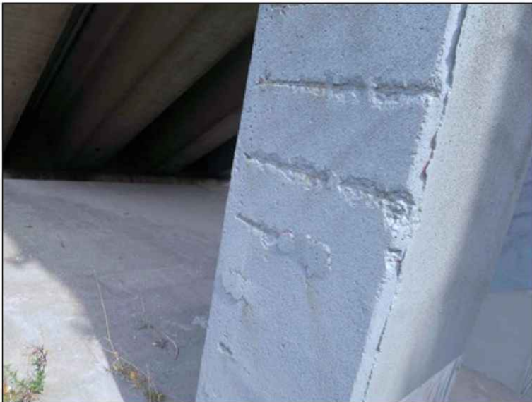
nekvalitně provedená sanace vzhledu v místě obnažené korodující smykové výztuže
