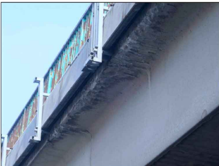
separace krycí vrstvy nad korodující výztuží u pravé konzoly, hloubková degradace betonu konzoly
