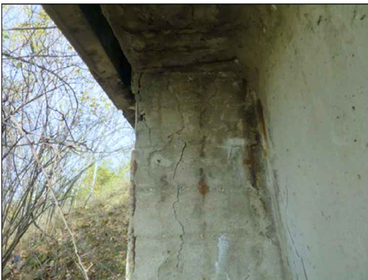
separace krycí vrstvy nad korodující výztuží u ZZ O1
