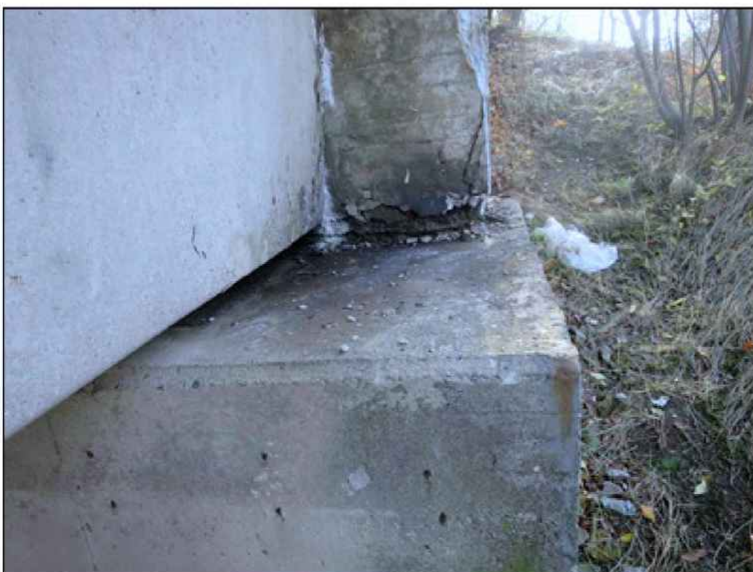
stopy po průsacích na ÚP O4
