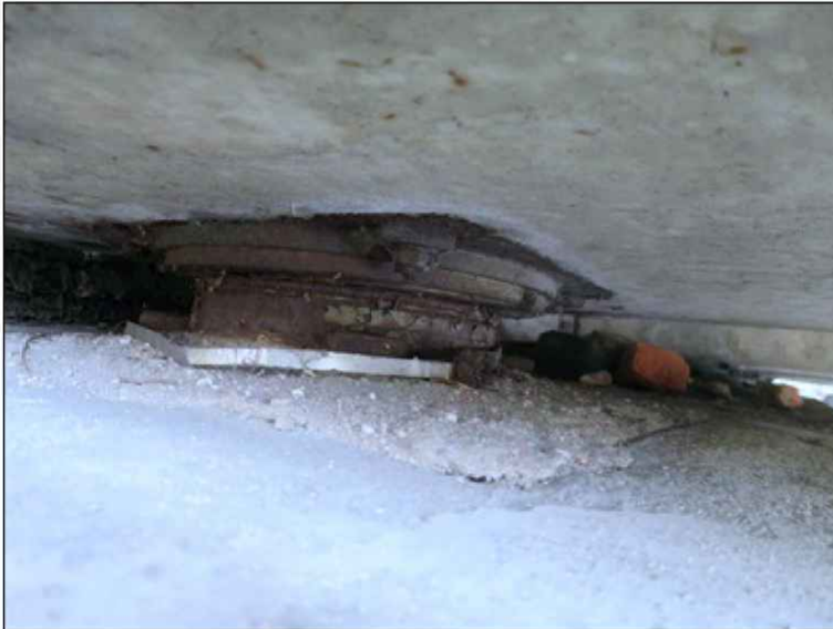
totální koroze ložiska na O1
