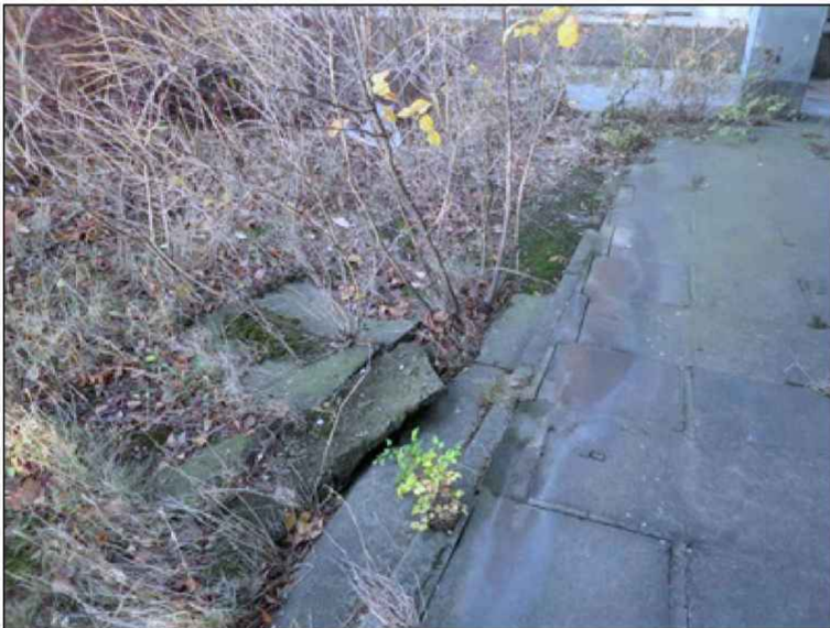
rozpad odvodňovacích skluzů
