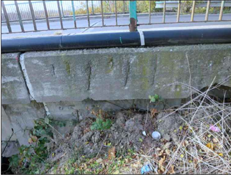
degradace betonu římsy, koroze obnažené výztuže
