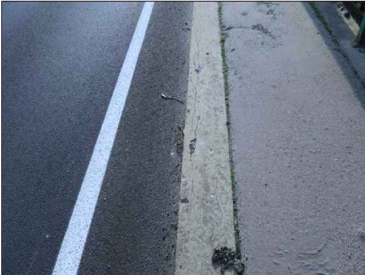
trhliny v obrubě jsou způsobeny mrazovým rozpadem
