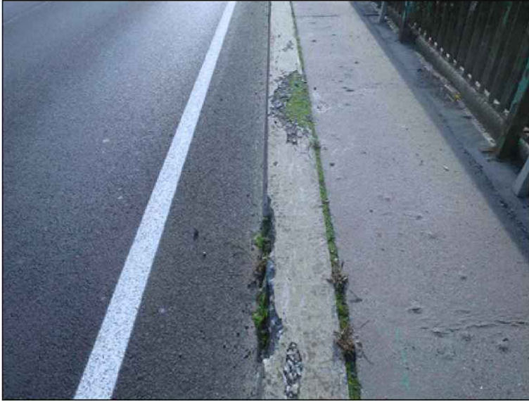
rozpad betonu obruby
