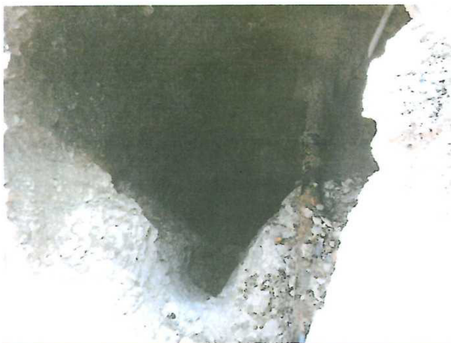
Obr. č. 3 Celkový pohled do ústí propadu, původní tvar jámy zřetelně přetvořen vodou.
