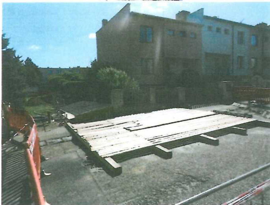
Obr. č. 4 Celkový pohled na místo s oběma propady pod provizorními povaly
