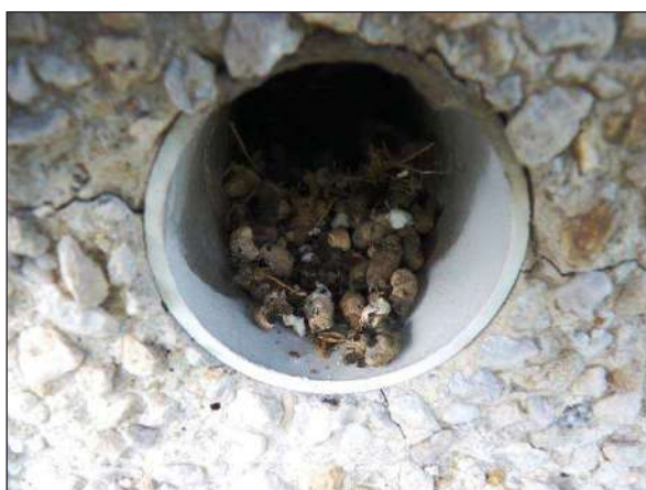
Trus rorýse obecného v ústí ventilačního otvoru
