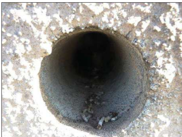
Trus drobných pěvců v ústí ventilačního otvoru
