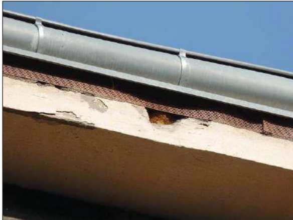
Detail poškození římsy – vletový otvor do hnízda
