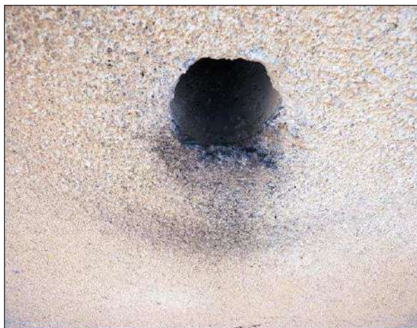
Znečištění fasády pod ventilačním otvorem, způsobené otěrem rýdovacích per pěvců
