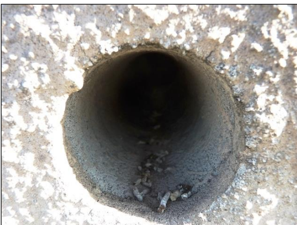
Trus drobných pěvců v ústí ventilačního otvoru
