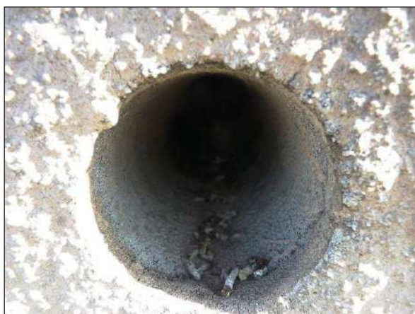
Trus drobných pěvců v ústí ventilačního otvoru
