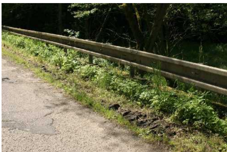
Římsa a svodidlo vlevo ve směru staničení - zanesená krajnice, vegetace uchycená podél vozovky, vysprávkování vozovky na mostě
