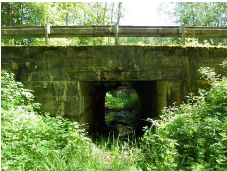
Pohled na levý bok NK (rozšíření) - trhliny a průsaky na povrchu spodní stavby, degradace betonu
