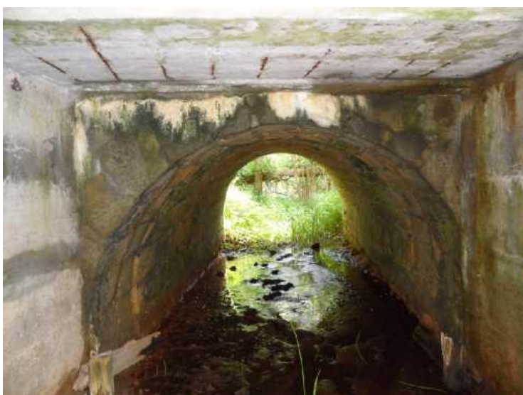
Pohled po proudu vodoteče na rozhraní mezi původním mostem a jeho rozšířením - zatékání, výluhy a degradace zdiva spodní stavby a nosné konstrukce.
