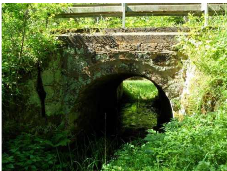
Pohled na most zleva ve směru staničení - vegetace na horních hranách křídel a čelní zídce, degradace zdiva, zanesené koryto vodoteče
