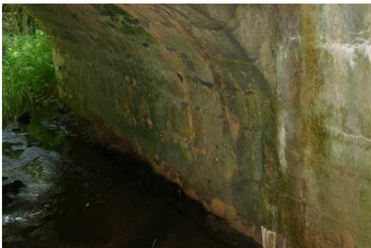
Pohled na opěru 1 - degradace kamenného zdiva v úrovni hladiny vodoteče, vodorovné trhliny s průsaky v monolitickém rozšíření spodní stavby.
