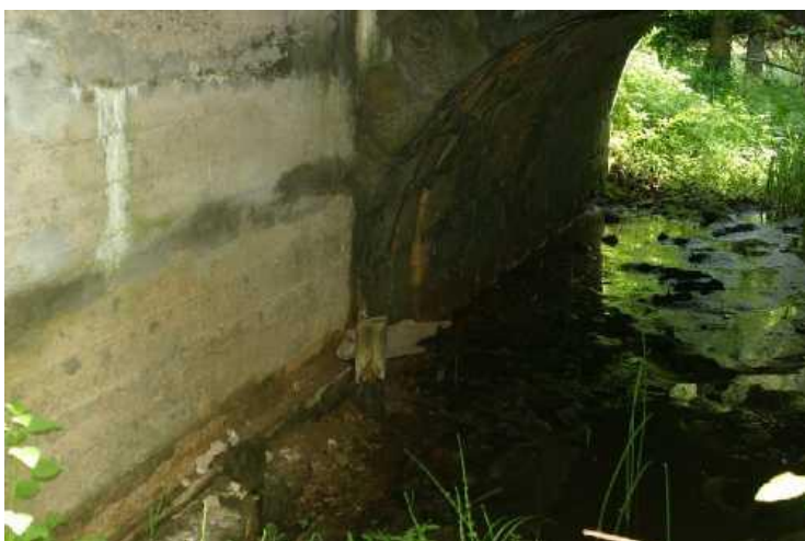
Pohled na rozšíření opěry 2 - zbytky dřevěné konstrukce v patě opěry, vodorovná trhlina s průsakem a výluhy, trhlina v místě napojení na původní kamennou opěru.
