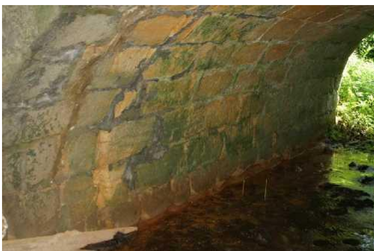
Pohled na opěru 2 původního mostu vpravo - degradace kamenného zdiva v úrovni hladiny vody v korytě, vlevo patrné starší svislé trhliny (nyní bez známek pohybu)
