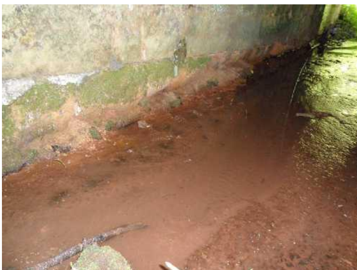
Detail degradace kamenného zdiva v patě opěry 2
