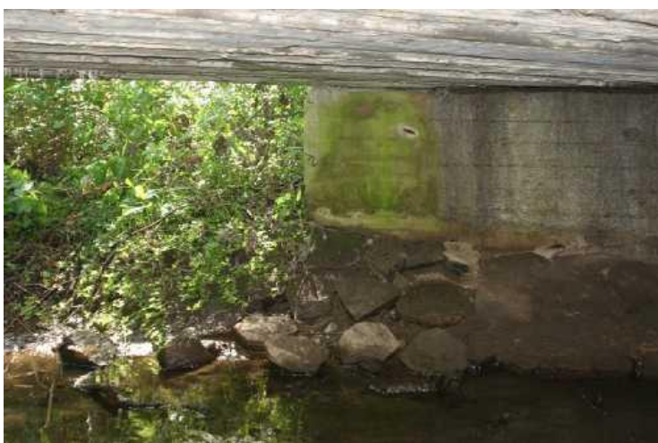
Rozpad kamenné dlažby u opěry 1 vpravo.
