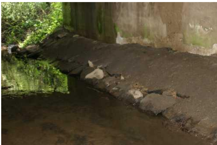
Rozpad kamenné dlažby u opěry 1.
