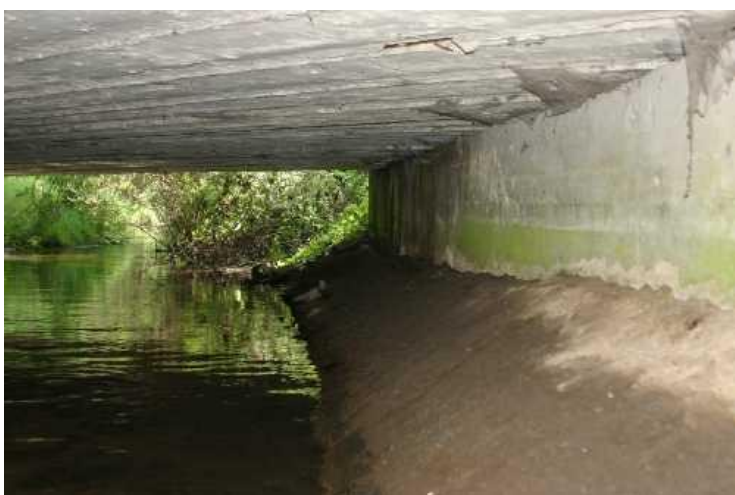
Pohled na opěru 1 - zatékání na úložný práh (kraje opěry)
