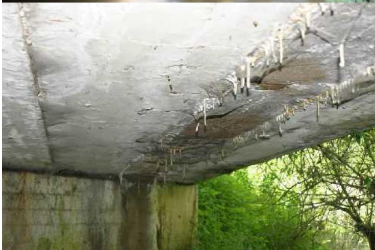
Detail zatékání spárami a výluhů mezi nosníky vpravo u opěry 2.
