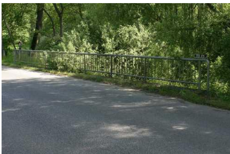
Pohled na pravou římsu - nečistoty podél římsy, uchycená vegetace, degradace PKO zábradlí.
