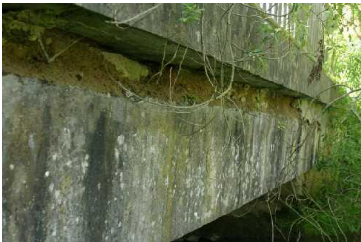
Levý bok nosné konstrukce mostu - totální degradace vyrovnávacího betonu a zatékání na boky nosné konstrukce.
