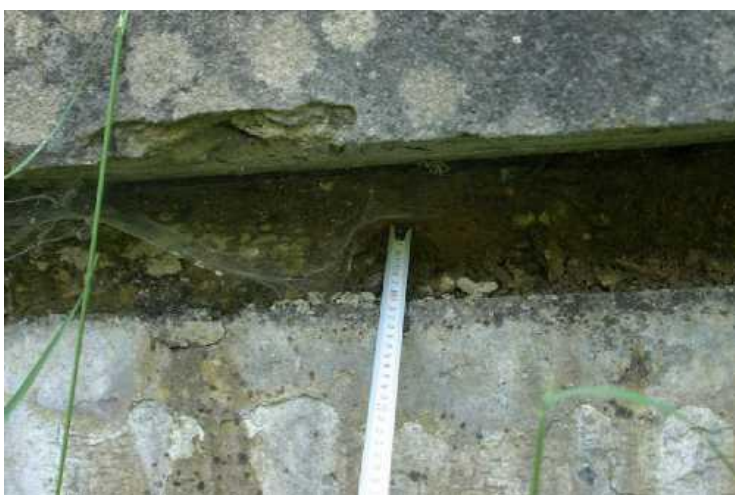
Detail degradace vyrovnávacího betonu pod římsami NK vlevo
