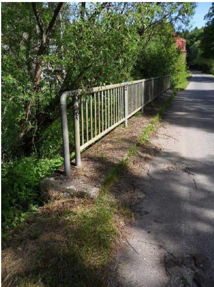
Levá římsa mostu - nečistoty podél římsy, uchycená vegetace, degradace PKO zábradlí
