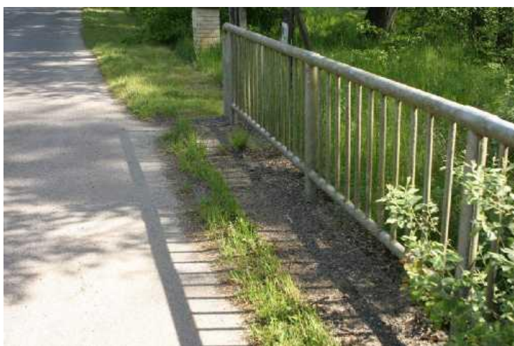
Detail pravé římsy u opěry 2 - nečistoty podél římsy, uchycená vegetace, degradace PKO zábradlí
