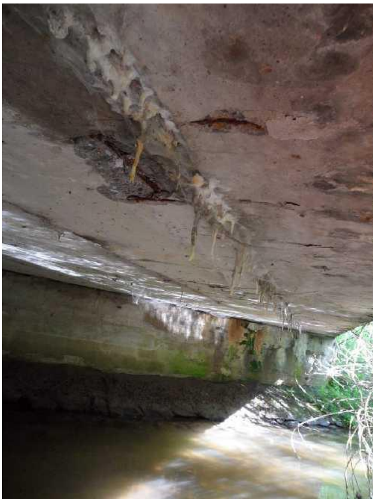
Podhled NK vpravo ve směru staničení - zatékání spárami mezi nosníky, obnažená korodující příčná a podélná výztuž prefabrikovaných nosníků.
