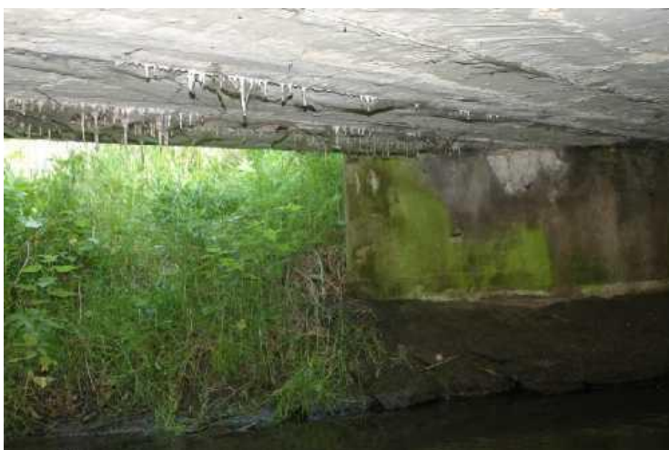
Levý okraj opěry 2 a podhled NK - zatékání a výluhy mezi krajními nosíky NK.
