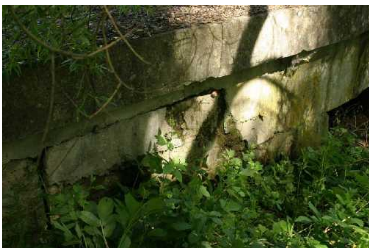
Pohled na pravý bok opěry 1 - zatékání a trhliny v místě ukončení NK.
