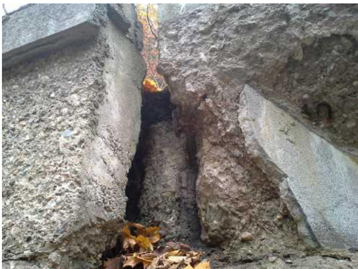
Degradace v místě napojení křídla na výtoku na pravém břehu
