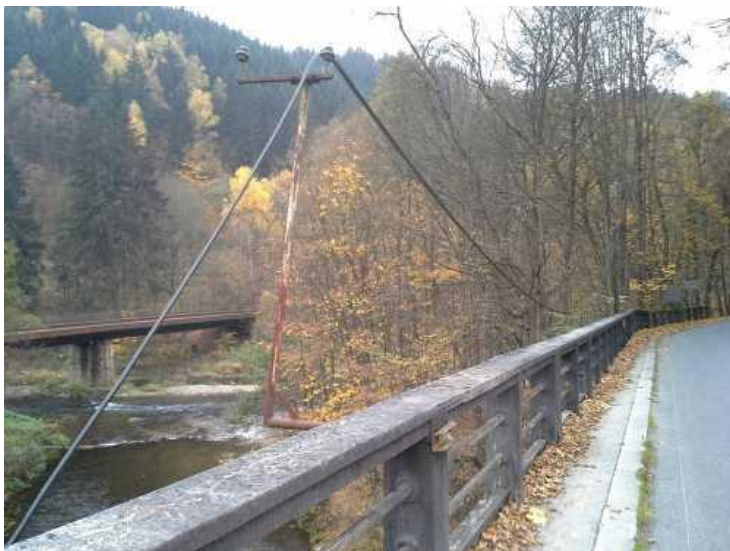
Uspořádání na římse, uchycení sdělovacího kabelu
