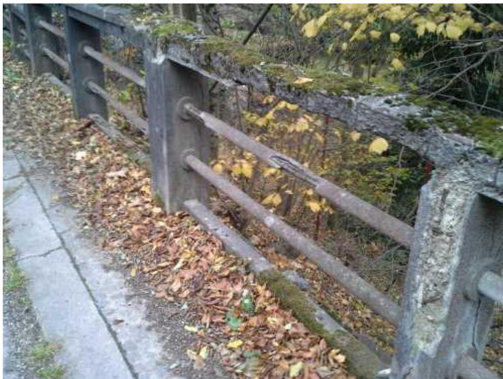
Uspořádání na římse, poruchy zábradlí
