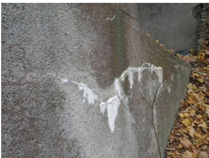
Projevy zatékání pod omítku na základovém bloku na pravobřežní podpěře
