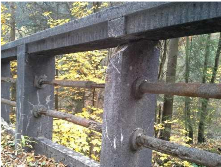
Uspořádání na římse, poruchy zábradlí, nánosy vegetace
