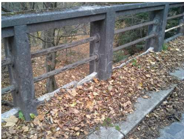
Uspořádání na římse, poruchy zábradlí, nánosy vegetace
