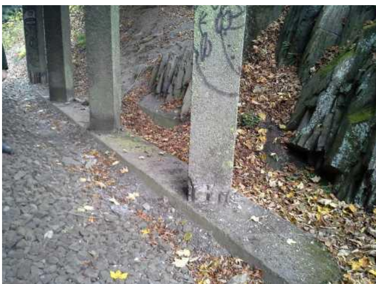
Poruchy v patě sloupů vnitřních podpěr
