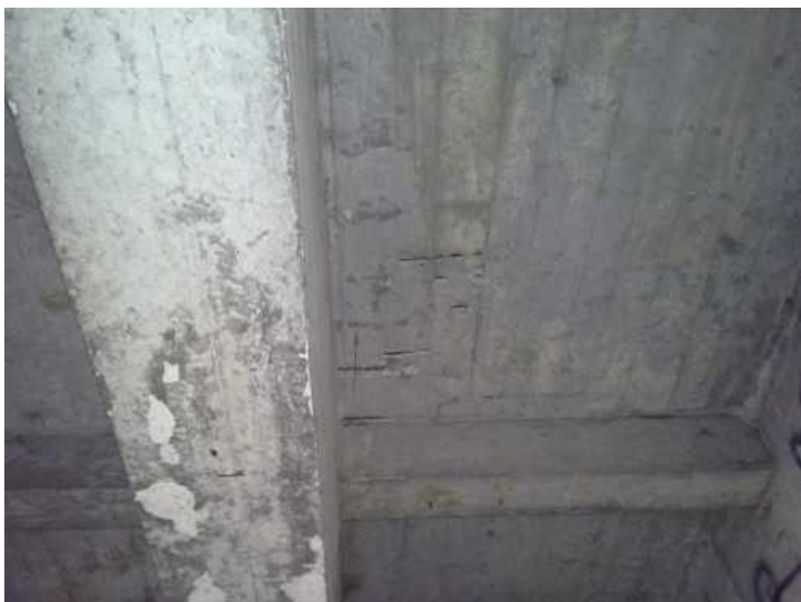
Lokální odpad krycí vrstvy na podhledu NK s korozí odhalené výztuže
