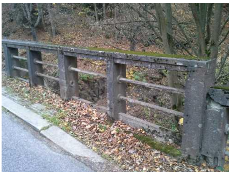
Uspořádání na římse, poruchy zábradlí, nánosy vegetace
