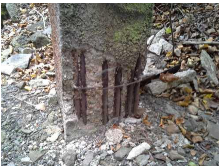
Poruchy v patě sloupů vnitřních podpěr
