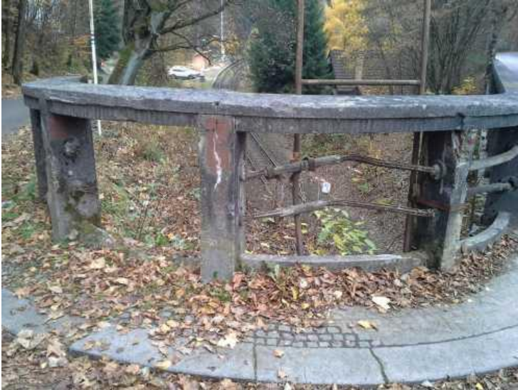
Uspořádání na římse, poruchy zábradlí, nánosy vegetace
