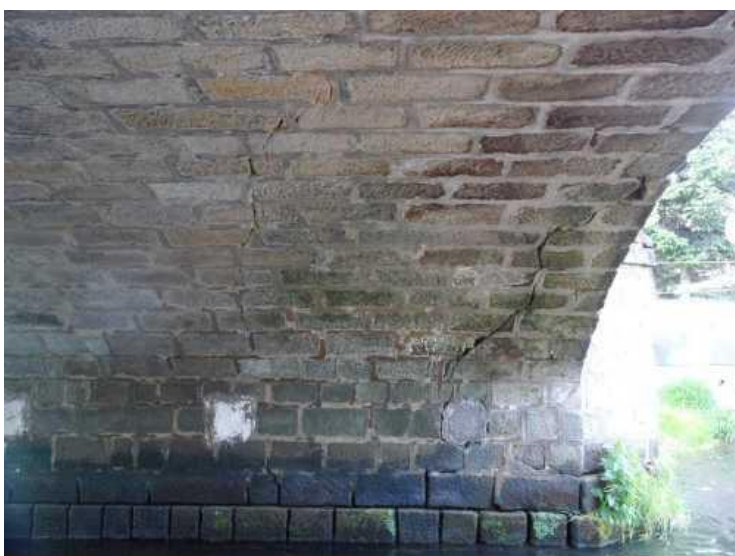
Pohled na návodní stranu pilíře 3 z pole 2 - rozvolnění zdiva pilíře a jeho zhlaví, pokles založení mostu a následné trhliny ve spodní stavbě a nosné konstrukci.
