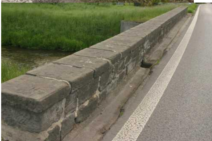
Pohled na levou parapetní zídku a římsu - přebalení vozovky, rozvolnění zdiva parapetní zídky
