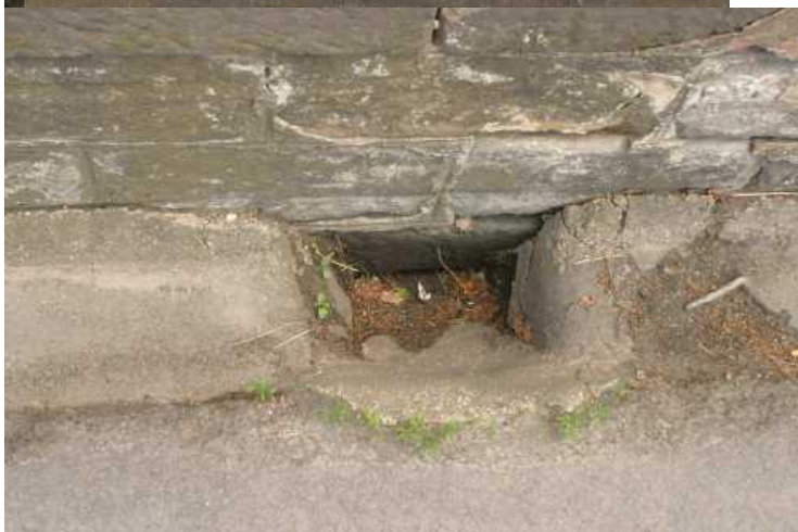
Detail odvodňovače vlevo - zanesení odvodňovače a chříče naplaveninami
