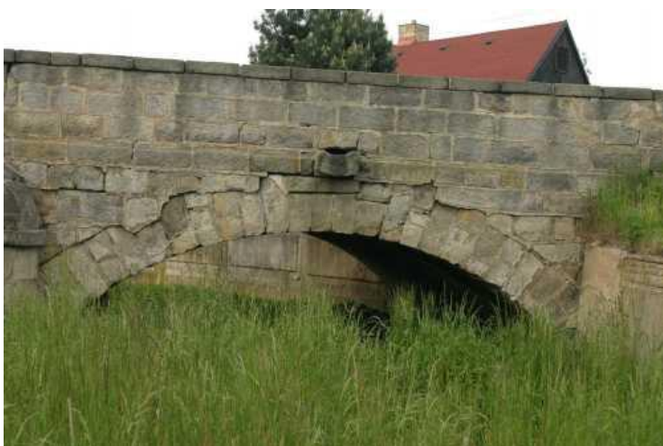
Pohled na pole 1 zleva - vysunutí zdiva čelní zídky a jeho povrchová degradace.
