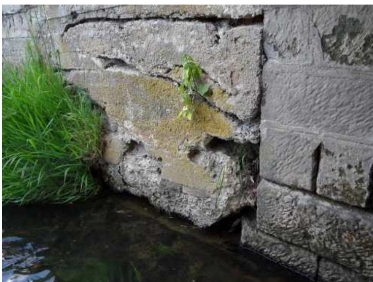
Detail degradace betonu monolitické dobetonávky levého křídla u opěry 4 v místě napojení na původní opěru.
