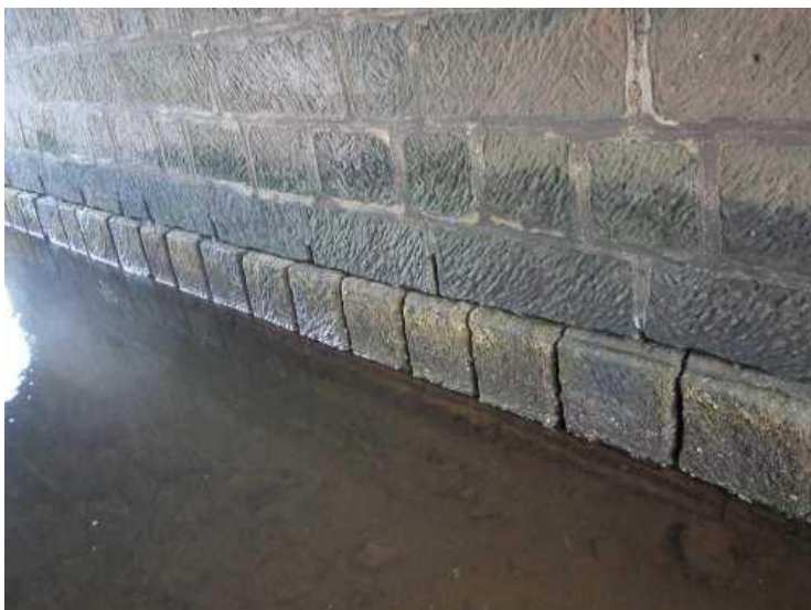
Typická povrchová degradace zdiva spodní stavby v úrovni hladiny vodoteče.
