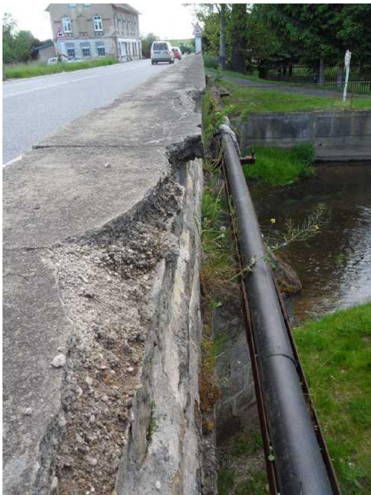
Detail degradace betonové římsy vpravo na parapetní zídce.
