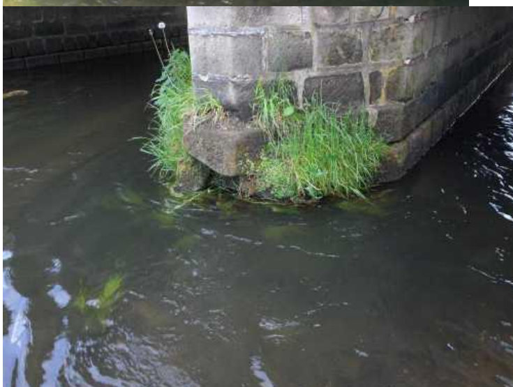
Detail degradace zdiva a podemletí návodního zhlaví pilíře 3.
