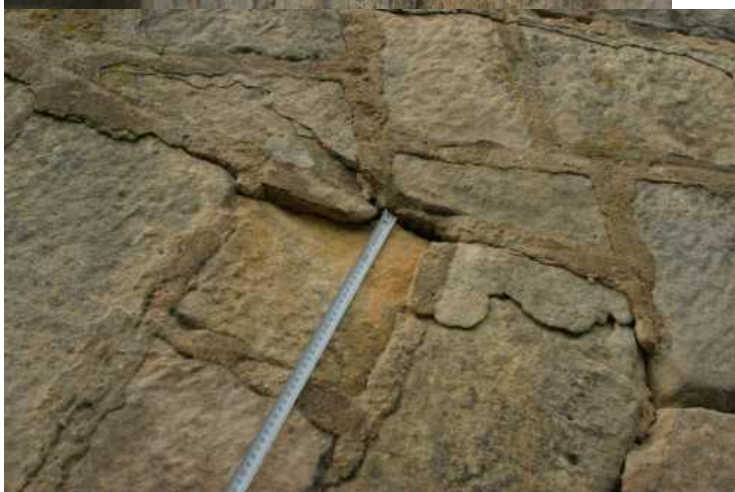
Detail obvyklé degradace zdiva klenby v poli 2 vlevo.
