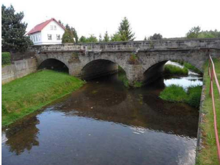
Pohled na most zprava - návodní strana - zanesení koryta vodoteče
