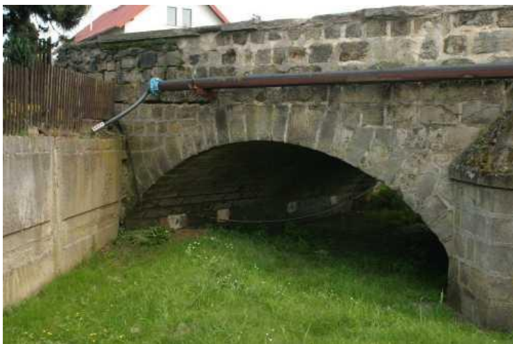
Pohled na pole 1 zprava - degradace zdiva parapetní zídky, uchycení vodovodního řadu a naplaveniny v mostním otvoru.
