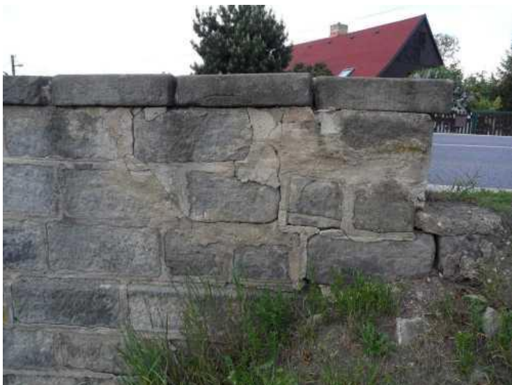
Rozvonění zdiva parapetní zídky vlevo na opěře 1
