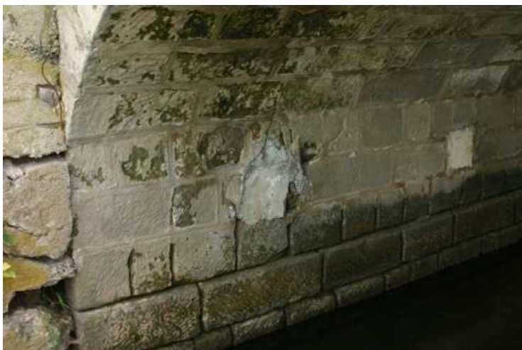
Pohled na levou část opěry 4 - poškození a následná sanace zdiva.
