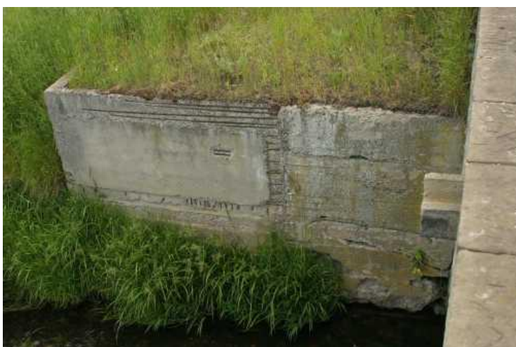
Křídlo vlevo u opěry 4 - degradace betonových prefabrikátů a monolitické dobetonávky, obnažená korodující výztuž
