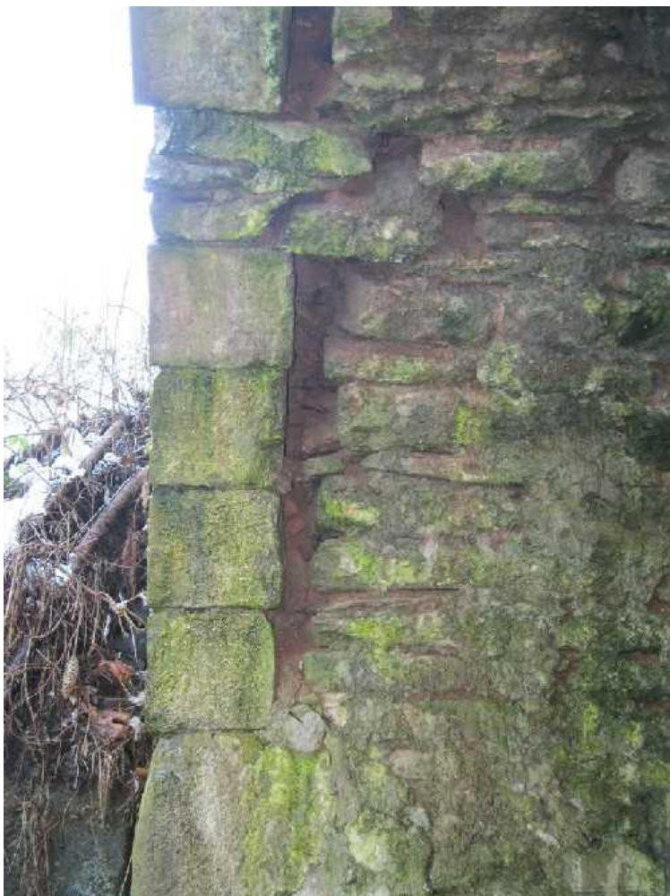
Odtržené čelní zdivo na výtoku
