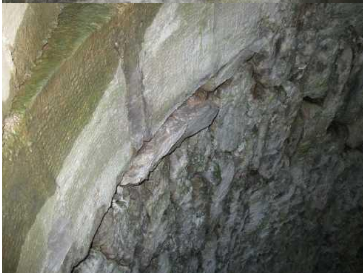
Vysunuté kameny na styku konstrukcí
