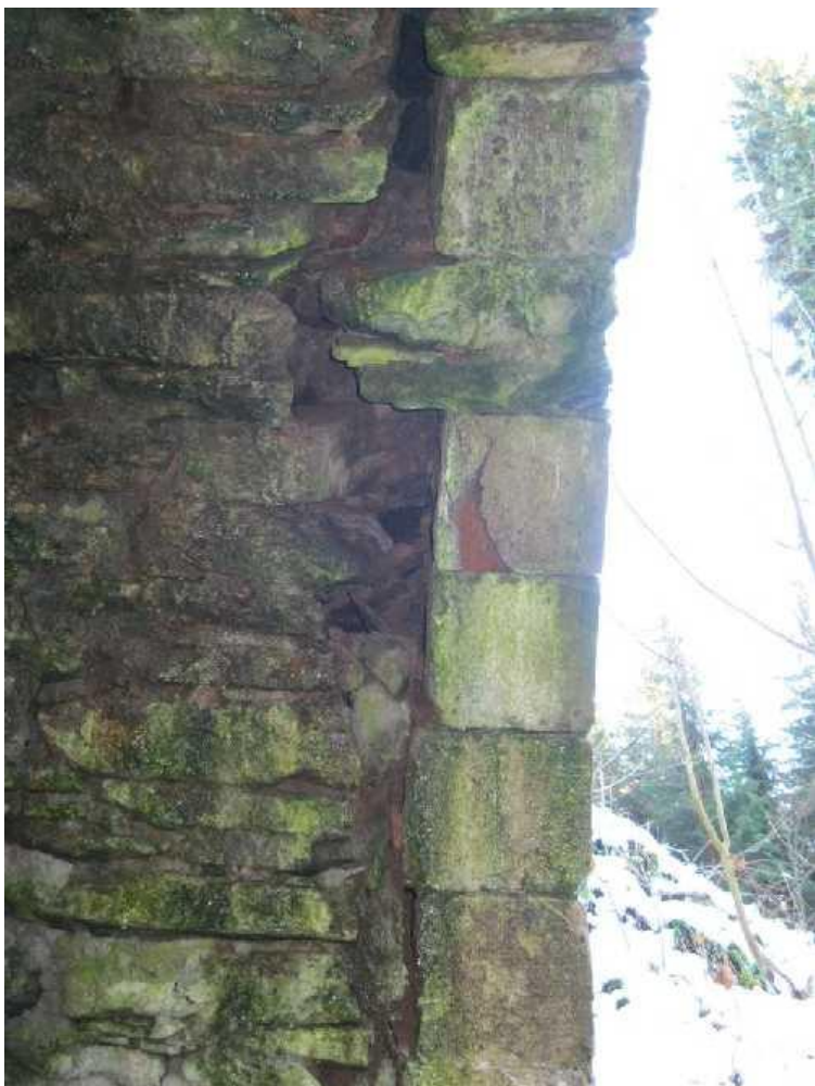
Odtržené čelní zdivo na výtoku
