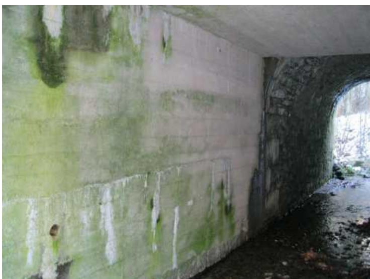
Protékání skrz betonové opěry
