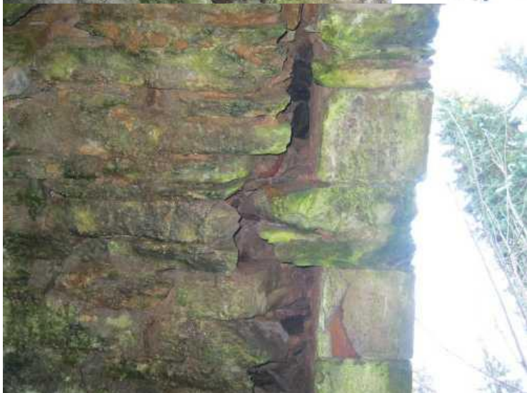
Odtržené čelní zdivo na výtoku
