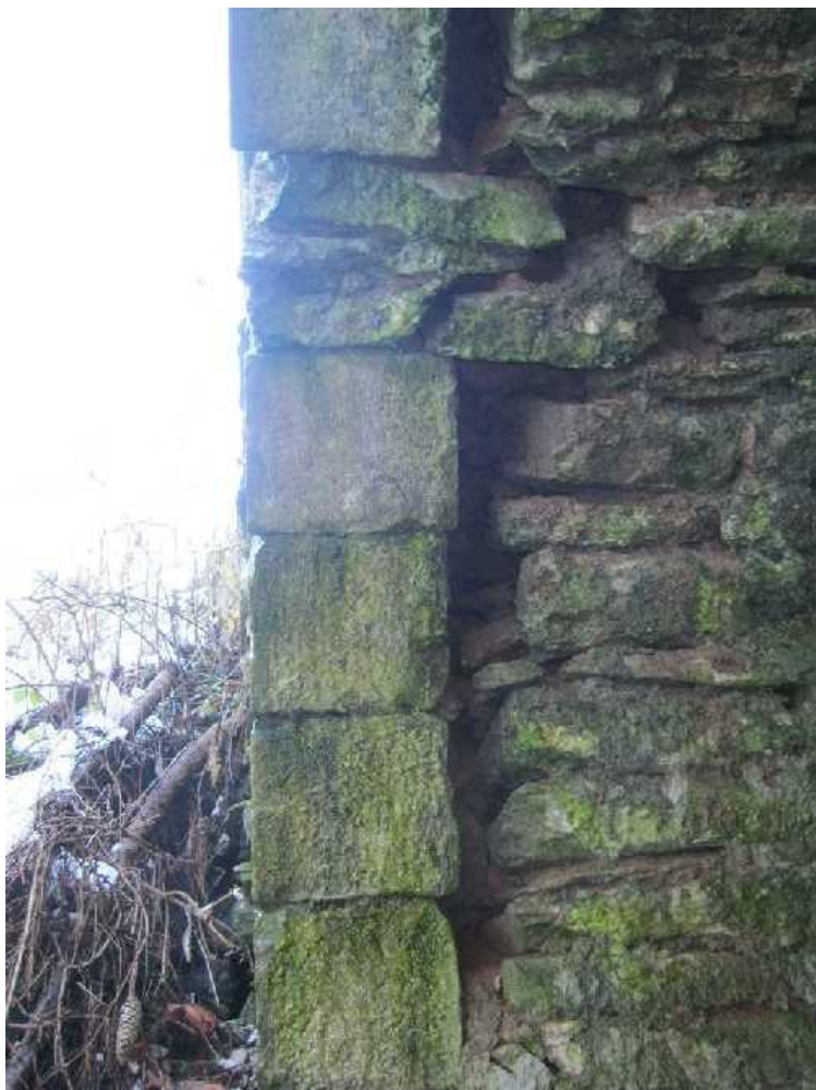
Odtržené čelní zdivo na výtoku
