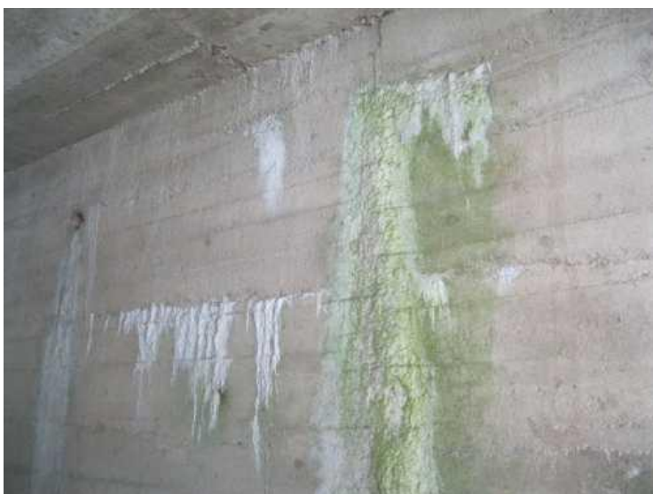
Protékání skrz betonové opěry
