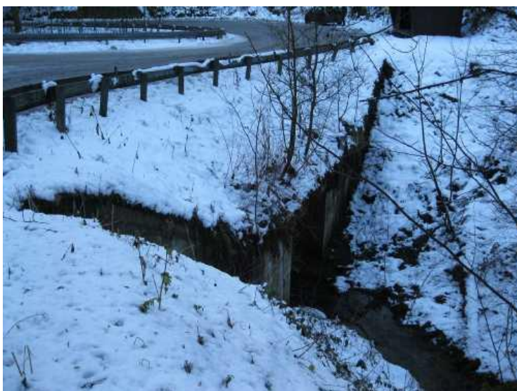
Vegetace na vtokové římse
