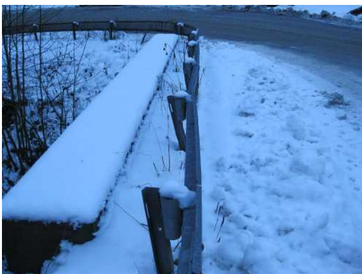
Poškozená svodidla od nárazů
