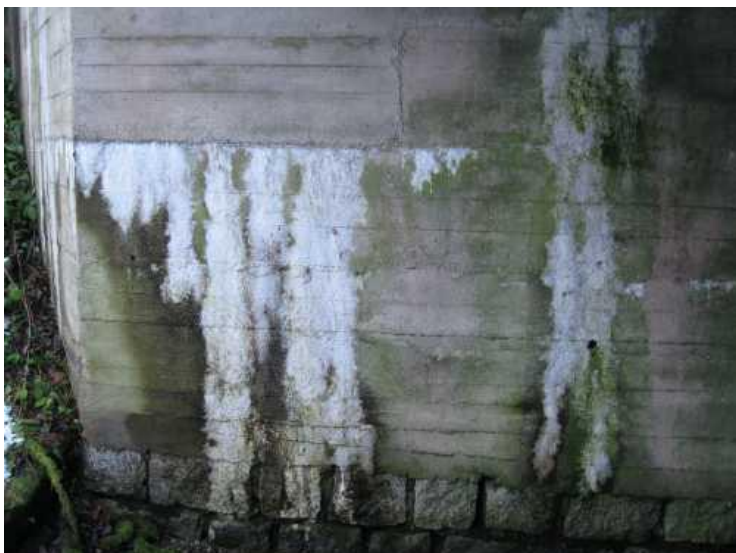
Protékání skrz betonové opěry
