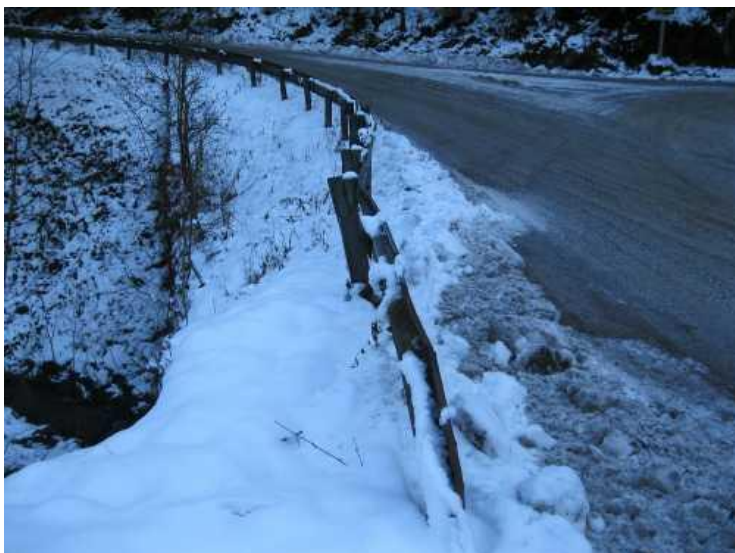
Poškozená svodidla od nárazů
