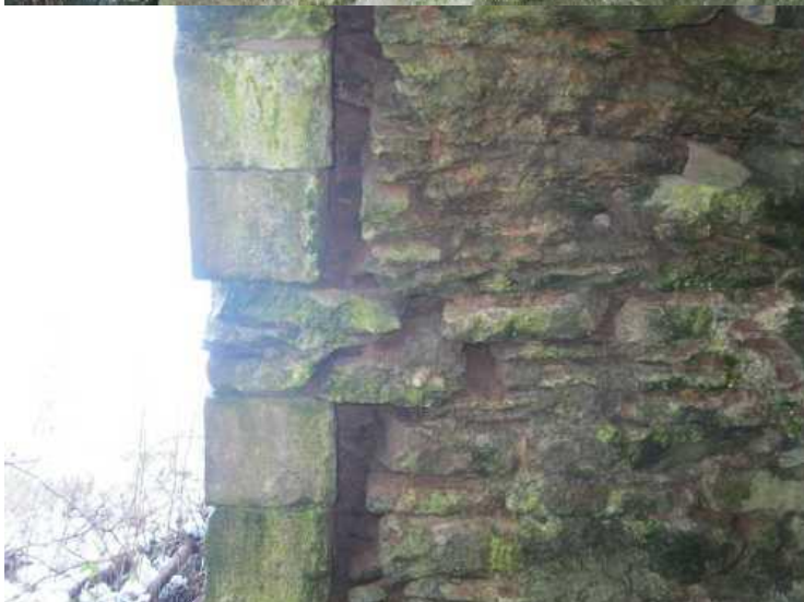
Odtržené čelní zdivo na výtoku
