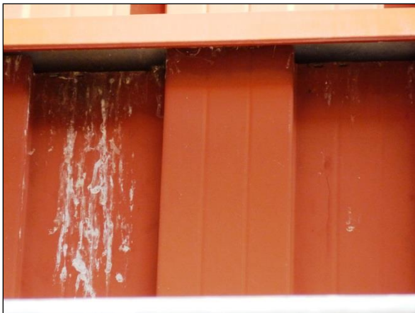
Prostor pod vletovým otvorem pěvců je často znečištěn trusem
