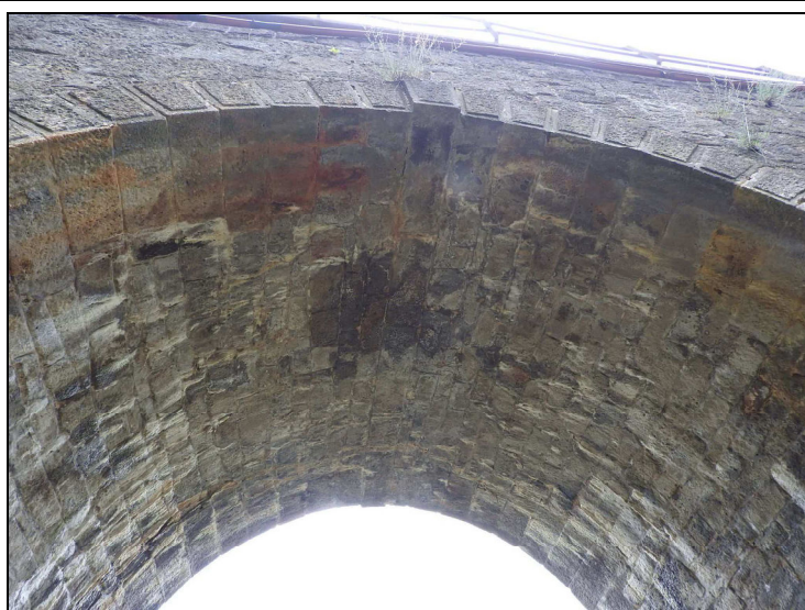
Foto Ā. 1 Ā Konstrukce K 01 Ā průsaky vody s vřluhy pojiva
