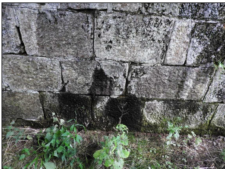
Foto č. 4 Ā Opěra O 01 Ā průsaky vody
