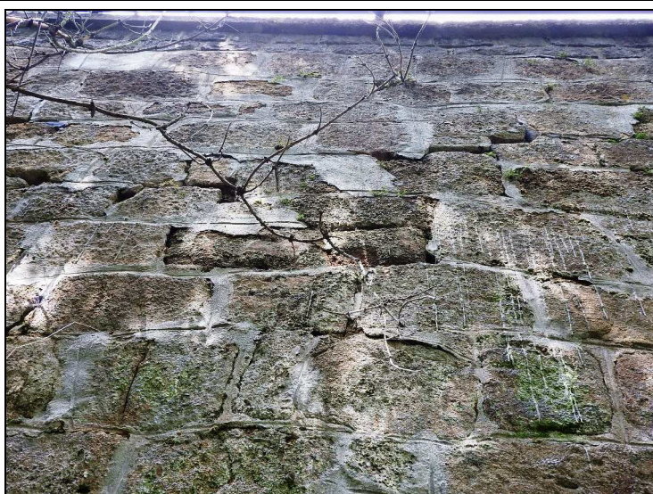
Foto č. 6 Ā Křídlo opěry O 01 vpravo Ā vypadaná spárovací zdiva, zvětravaná zdiva
