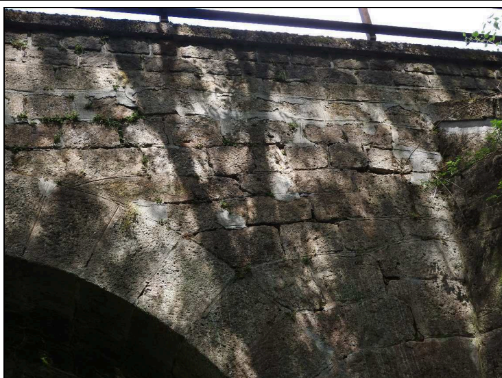
Foto č. 3 Ā Kontrukce K 01 Ā řelnř zed' vpravo Ā poruřenř spřrovřř zdiva
