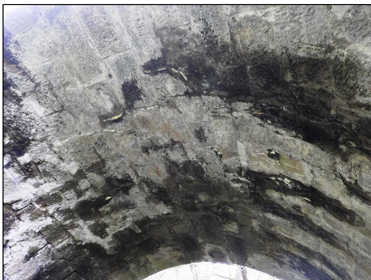
Foto č. 1 Ā Kontrukce K 01 Ā z podhledu NK Ā průsaky vody s vřluhy pojiva
