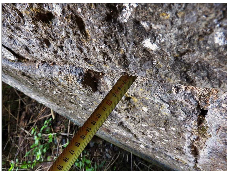
Foto č. 5 Ā Opěra O 02 Ā vypadaná spárovací zdiva Ā detail
