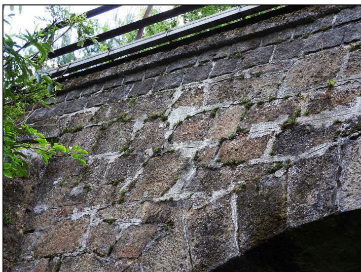
Foto č. 2 Ā Kontrukce K 01 Ā řelnř zed' vlevo - poruřenř spřrovřř zdiva, vegetace
