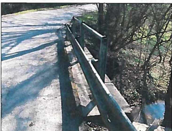
Poškozená PKO svodidel
