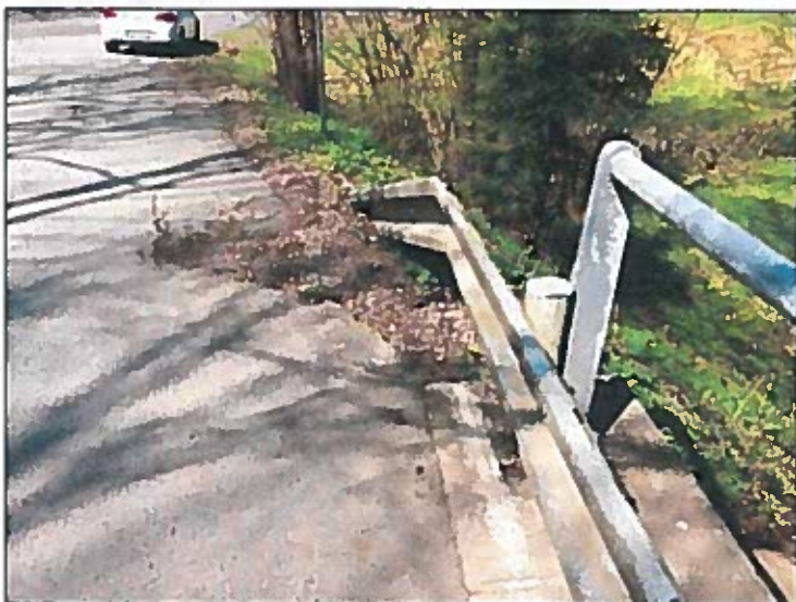
Pokles vozovky na pravé straně za OP2
