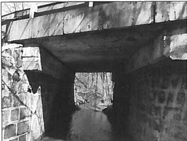
Zatékání pod římsou na kraje NK
