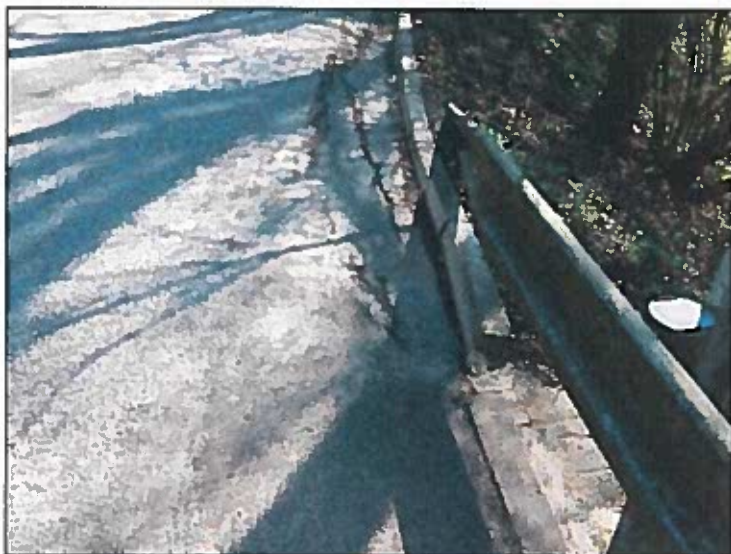
Utržená silnice na levé straně u OP1
