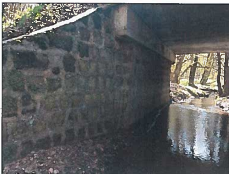
Pohled na OP1, zatékání na UP
