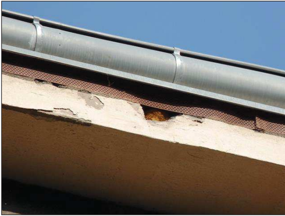
Detail poškození římsy – vletový otvor do hnízda
