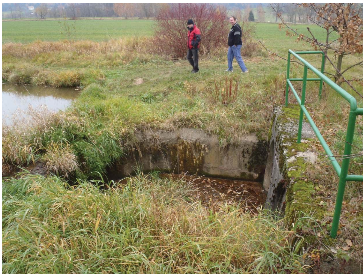
Obrázek 3. Průsak hrázi podél objektu bezpečnostního přelivu
