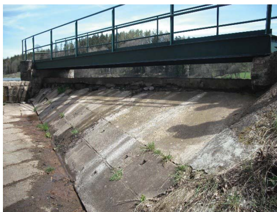
Obrázek 4. Odtržená koruna bočního bezpečnostního přelivu od spodní konstrukce
