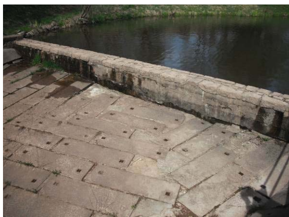
Obrázek 3. Průsak pod korunou čelního bezpečnostního přelivu
