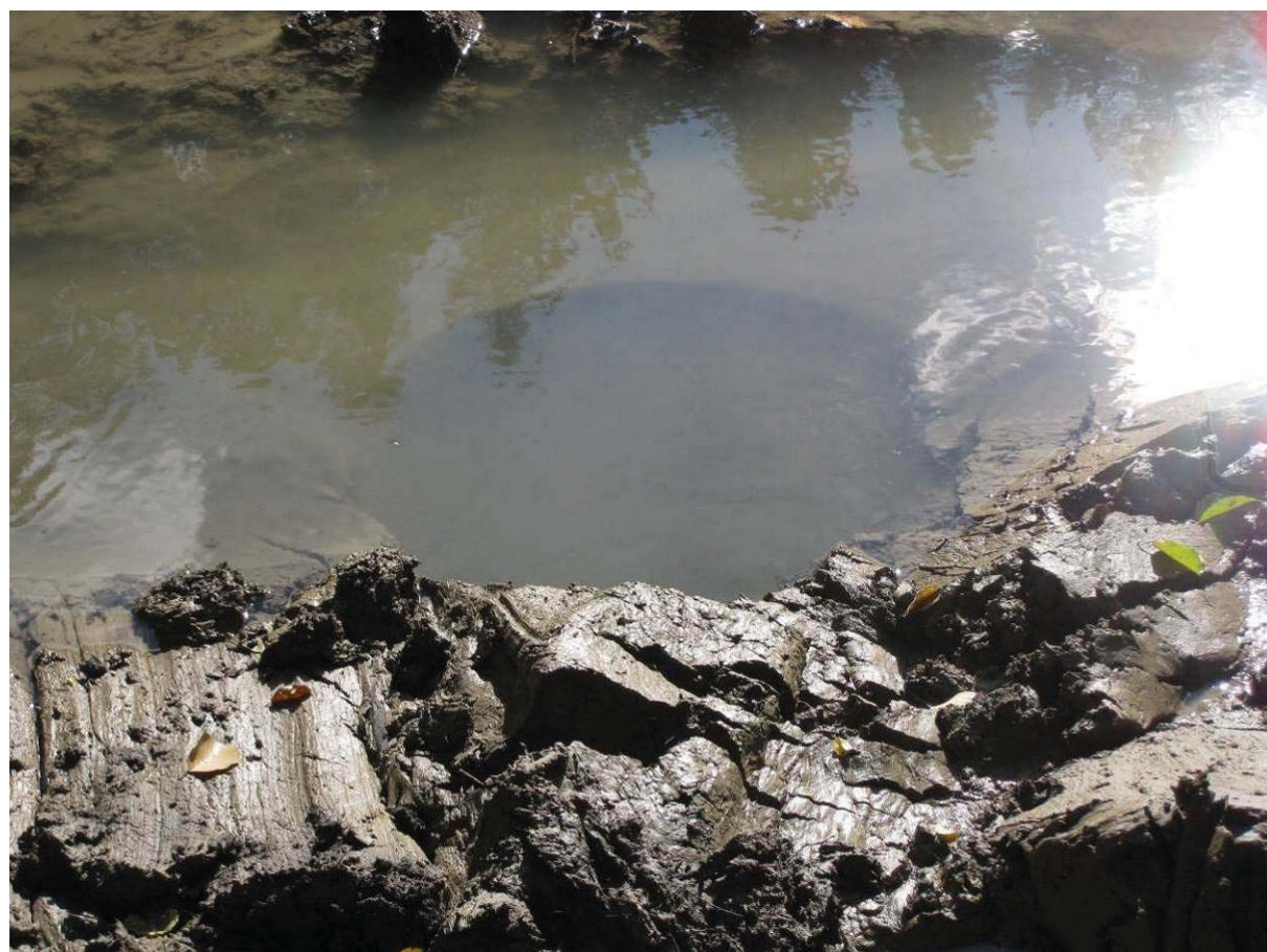
Obrázek 3. Vývěr vody na vzdušní patě hráze
