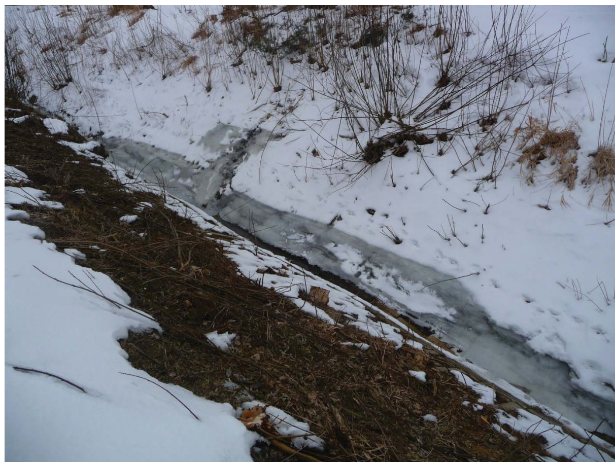
Obrázek 3. Průsak vody na vzdušním líci boční hráze v km 0,240.
