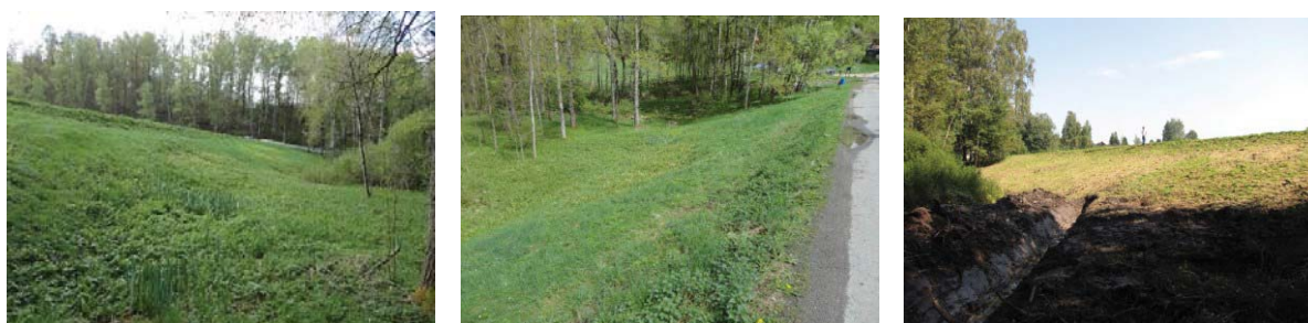
Obrázek 3. Propady a podmáčený terén na vzdušném líci hráze
