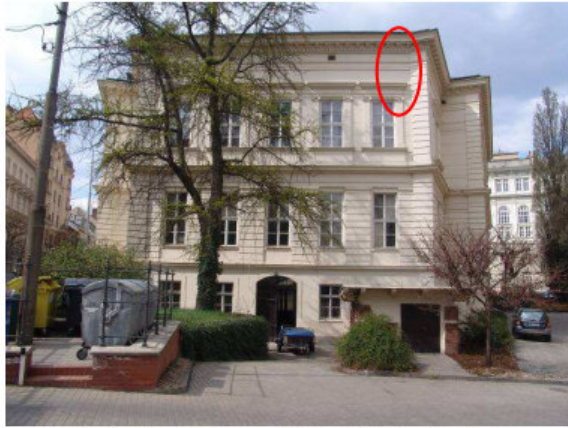
A – Lokalizace polohy trhliny JV obvodové stěny
