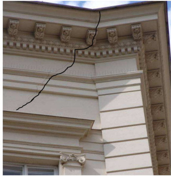
B – Detail trhliny JV obvodové stěny
