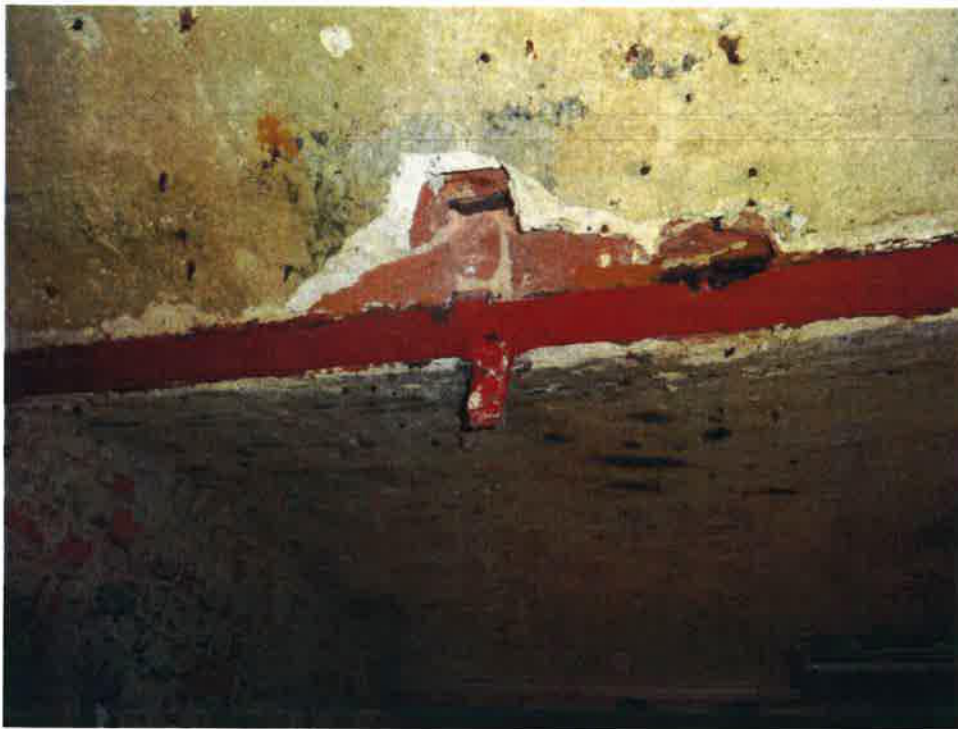
obrázek č.1 Pohled na strop nad 1.NP z valené cihelné klenby uložené do ocelových I nosníků ve střední části s velkým stupněm koroze
