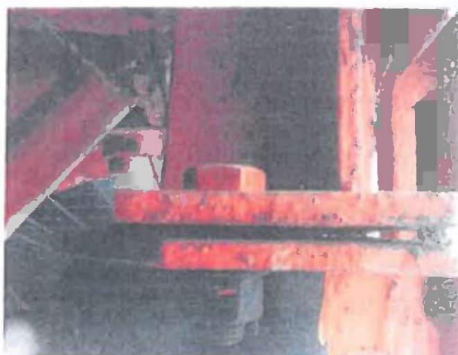
OBR: 19 – Rozevřené připoje mezi konstrukcí fasády a konstrukcí střechy
