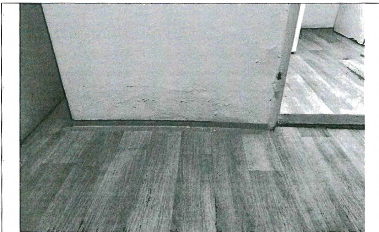
Obr. 7. Ukázka rozsahu poškození vlivem vlhkosti
