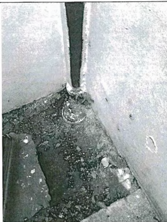
Obr. 4. Stav stávajících prvků odvodnění střechy a příklad poškození omítky vlivem vlhkosti
