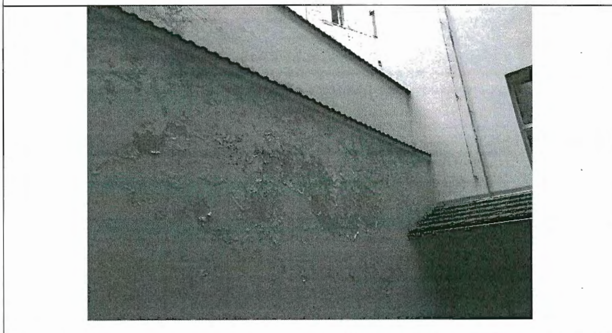
Obr. 2. Rozsah poškození povrchu opěrné zdi v návaznosti na schodiště přilehlé ke svahu
