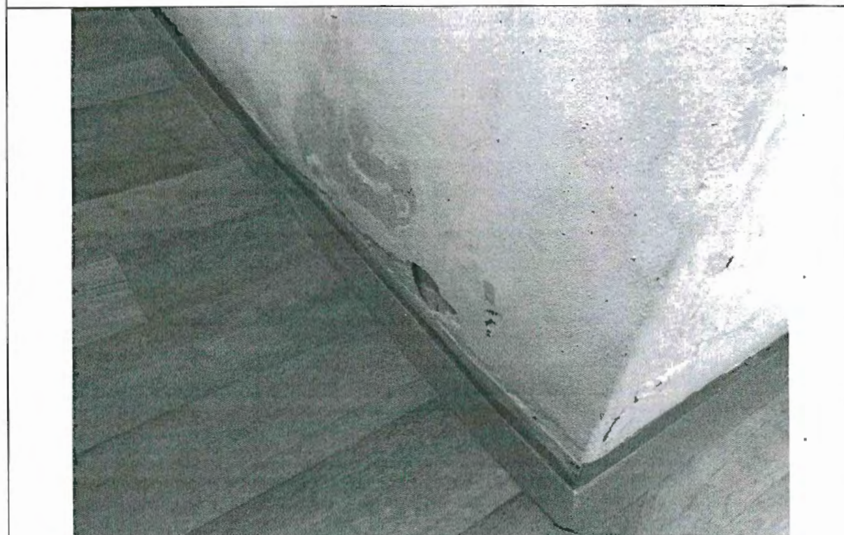
Obr. 6. Rozsah silného lokálního poškození v místnosti č. 109 (hala)
