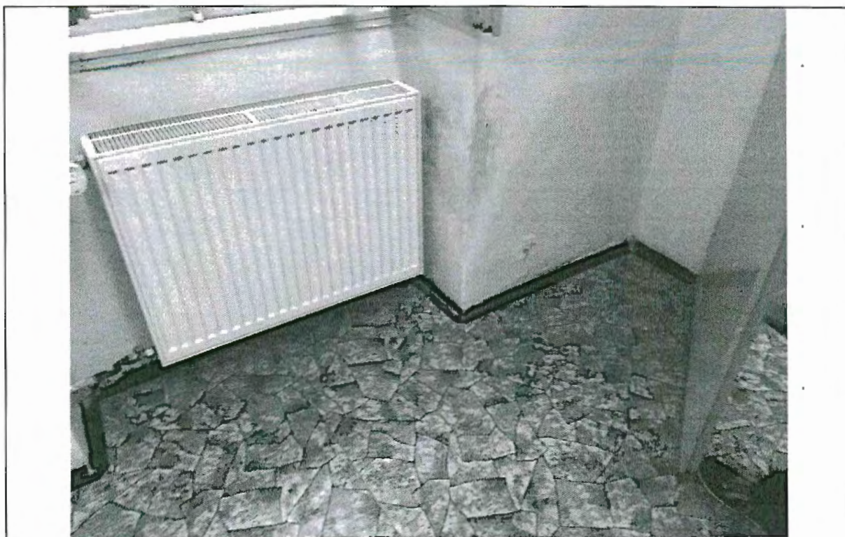
Obr. 5. Poškozená omítka vlivem vlhkosti v interiéru místnosti č. 115
