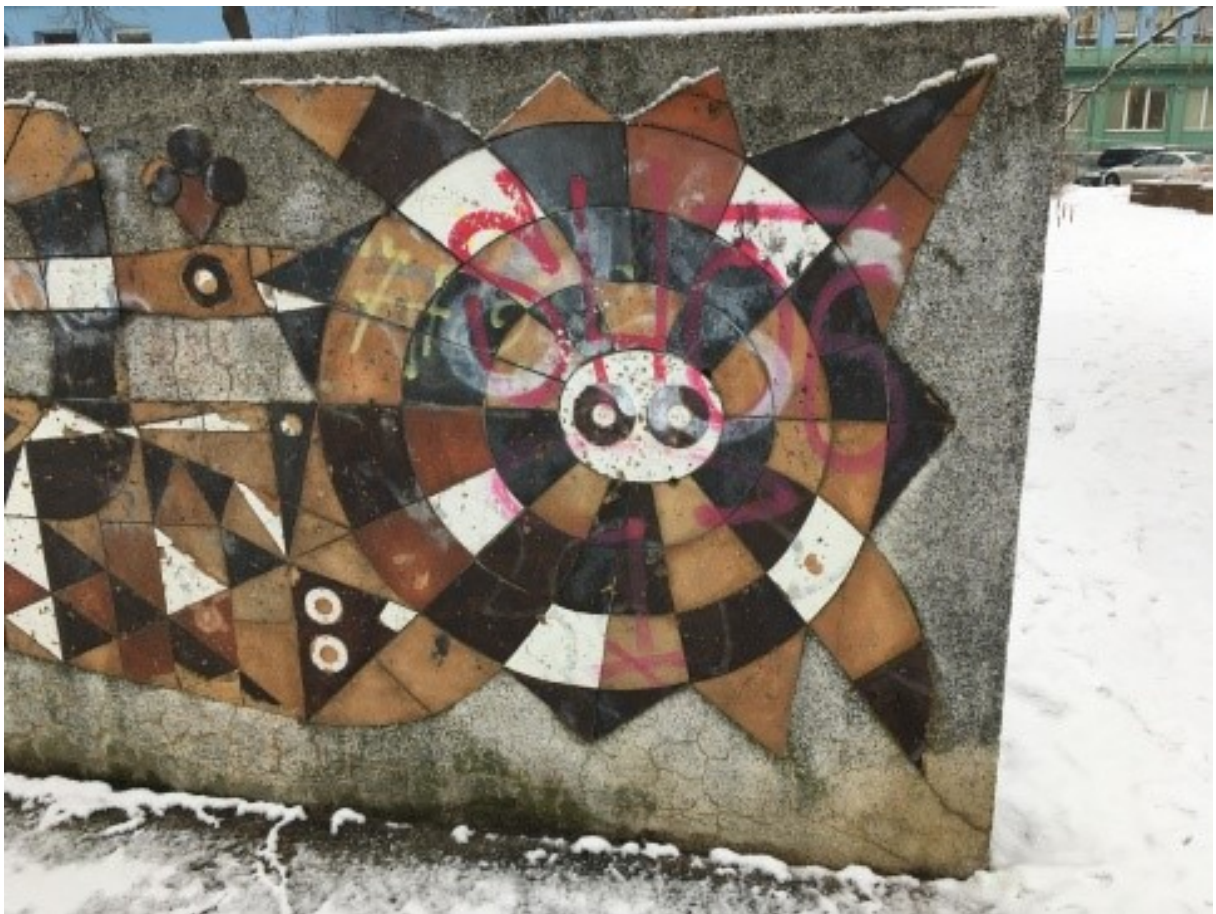
Současný stav – značné znečistení a poškodení díla
