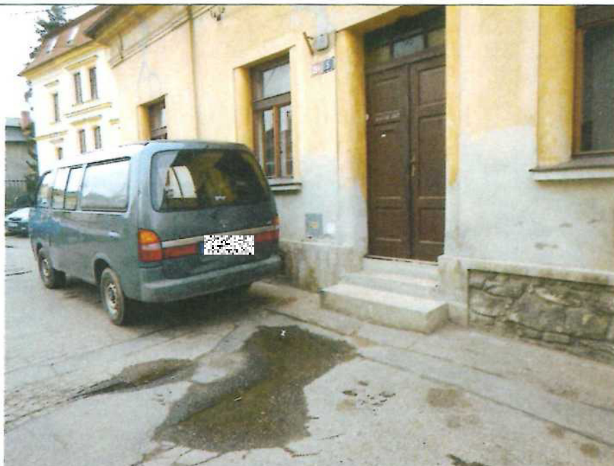
Obr. 02 Bližší pohled místo ohrožené propadem – hlavní uzávěr plynu a levá část ostění vchodových dveří
