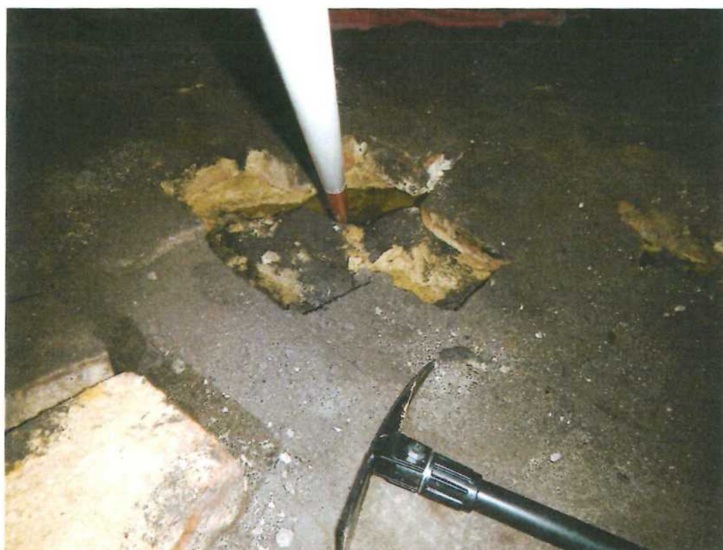
Obr. 10 Pohled na trasírku v rozvolněném podkladu podlahy
