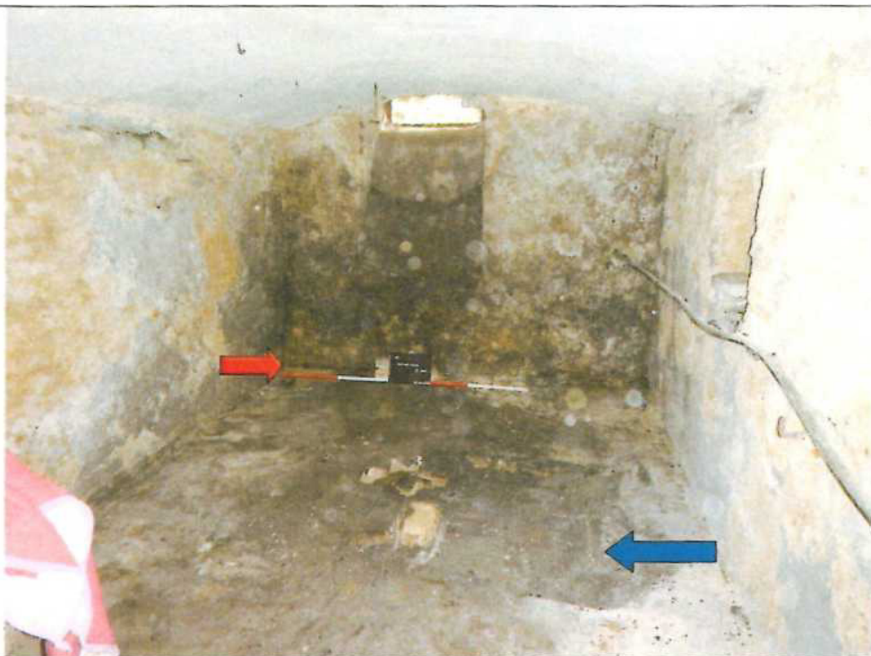
Obr. 03 Celkový pohled na sklep, modrá šipka označuje pokles, červená šipka propad v rohu
