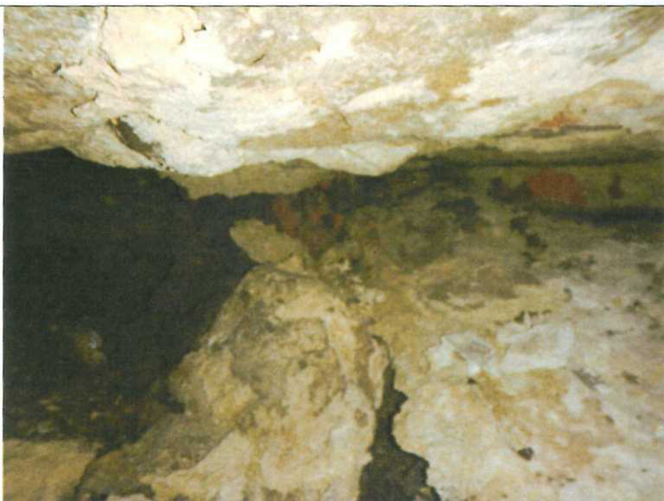
Obr. 07 Pohled na destrukci základů severní sklepní zdi
