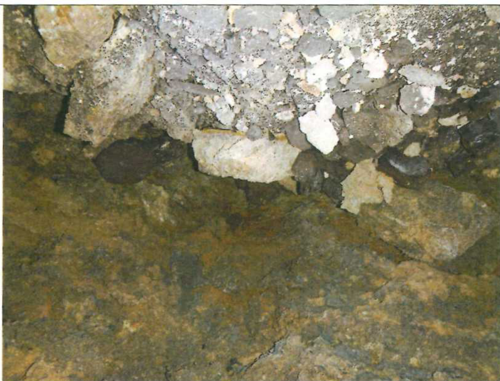
Obr. 08 Pohled na jižní stěnu propadu
