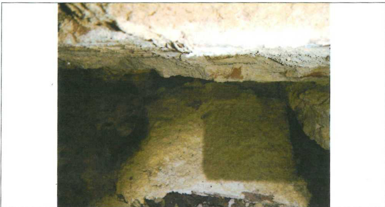
Obr. 06 Pohled na destrukci základů obvodové zdi domu
