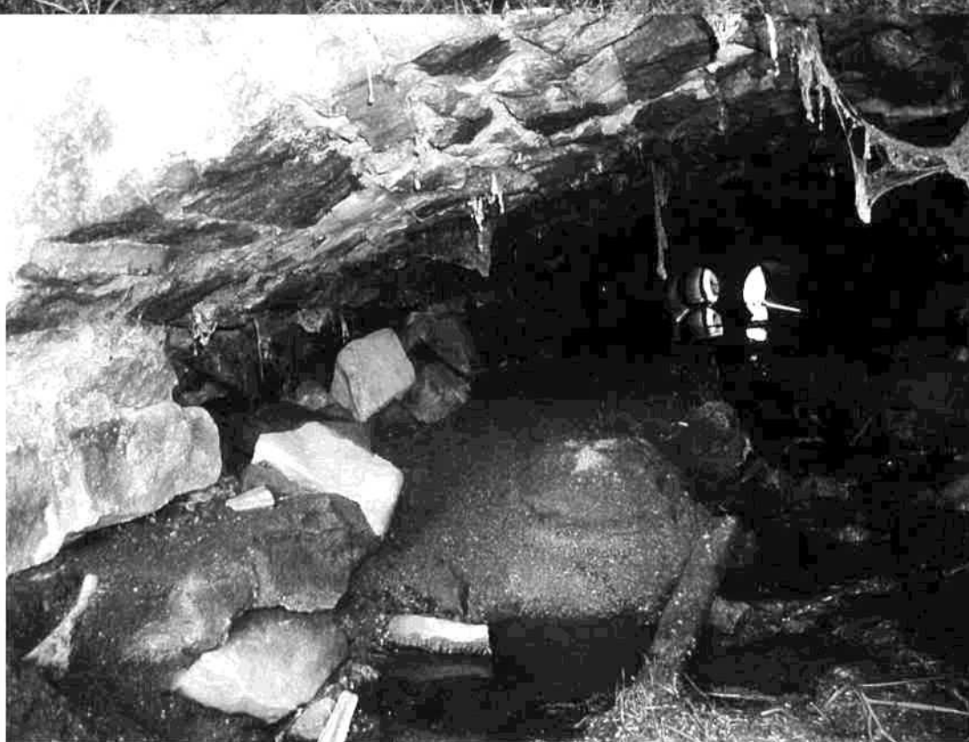
Foto: rozpadlé opěry klenby včetně trubního prodloužení mostu
