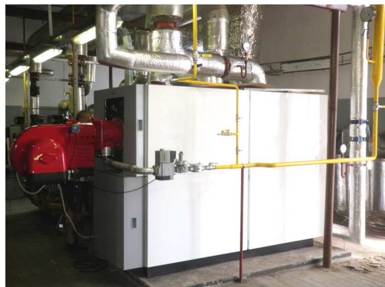
Nový kotel K3 instalovaný v roce 2013 místo kotle K3
