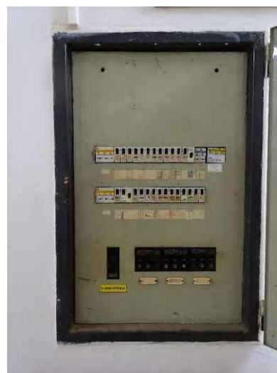
S8 – stávající napájecí rozvaděč v chodbě 1.NP
