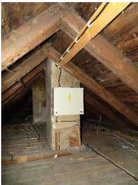
S20 – stávající rozvaděč sirény na půdě
