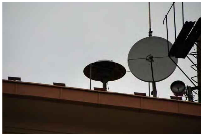
S9 – umístění sirény na stožáru na střeše
