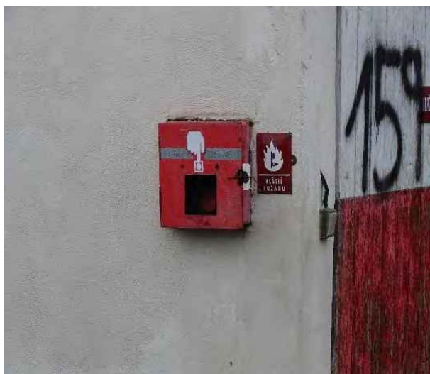
S14 – stávající tlačítko lokálního spuštění
