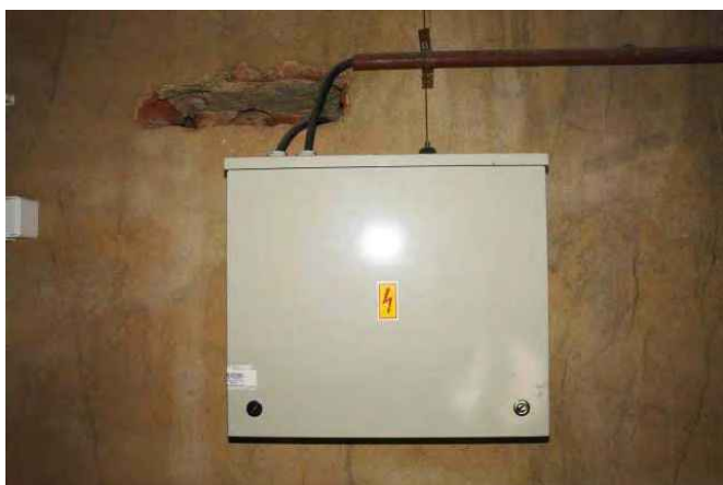
S19 – stávající rozvaděč sirény
