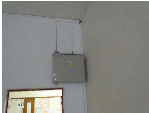
S18 – stávající rozvaděč sirény na WC
