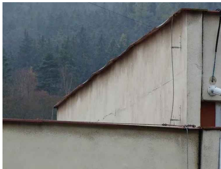
S11 – nová siréna na budově školy
