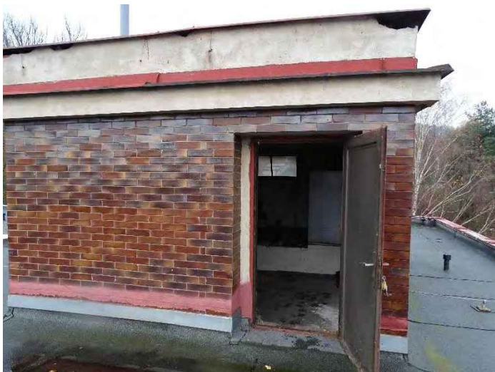
S8 – strojovna výtahu
