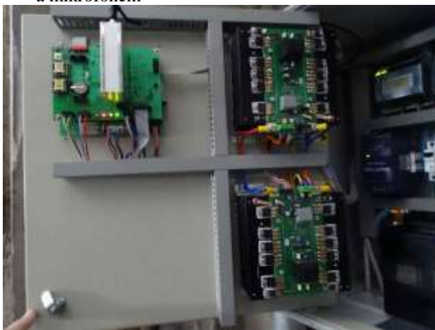
ES.13 – vnitřní vybavení ovládací skříně
