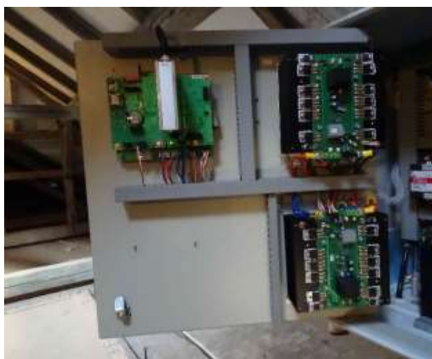
ES.1 – vnitřní vybavení ovládací skříně
