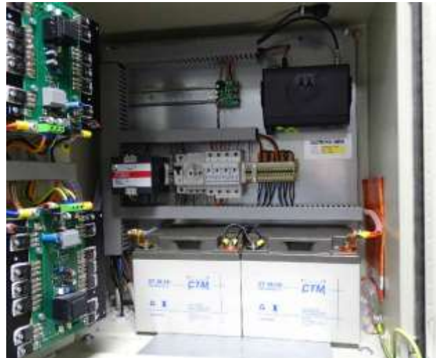
ESH.2 – vnitřní vybavení ovládací skříně
