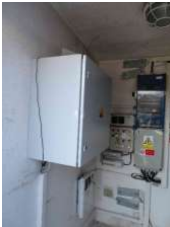
ES.10 – stávající řídicí skříň sirén v technické místnosti vodárny
