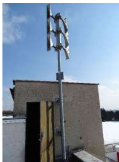
ES.11 – střecha, umístění stožáru na boční stěně schodiště, konfigurace ozvučnic 750s
