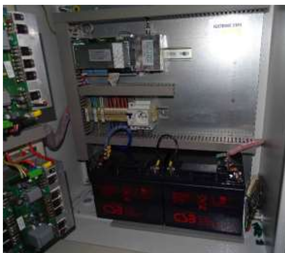
ES.26 – vnitřní vybavení ovládací skříně
