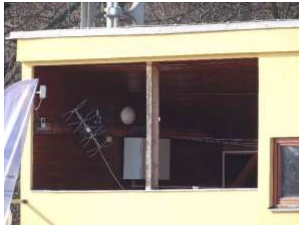
ES.6 – umístění rozvaděče a modulu VIS, anténa bude umístěna na střeše na výložník stožáru sirény
