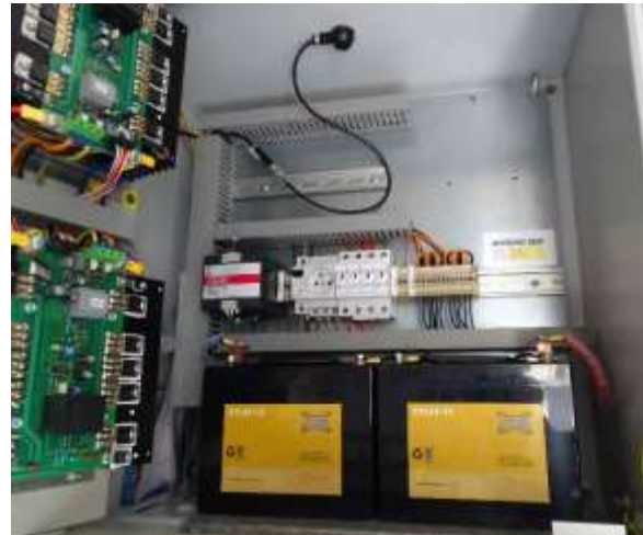
ES.3 – vnitřní vybavení ovládací skříně
