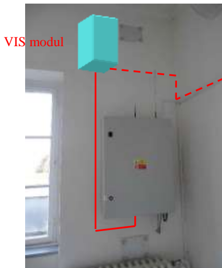
ESH.12 – vnitřní vybavení ovládací skříně
