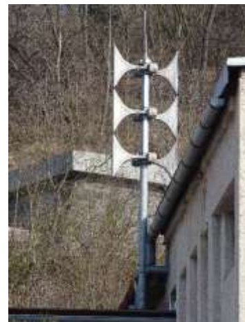
ES.7 – umístění modulu VIS, anténa bude umístěna na střeše na výložník stožáru sirény
