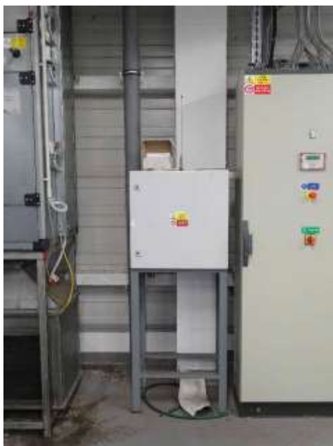
ESH.3 – stávající siréna strojovna VZT
