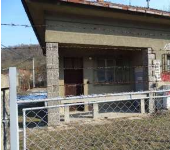
ES.2 – rozvaděč stávající sirény je na stěně vpravo za oknem
