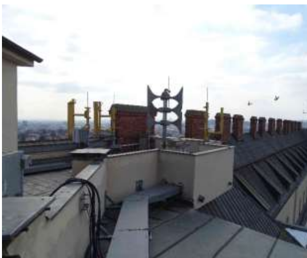
ES.17 – střecha VŠ, umístění stožáru s ozvučnicemi
