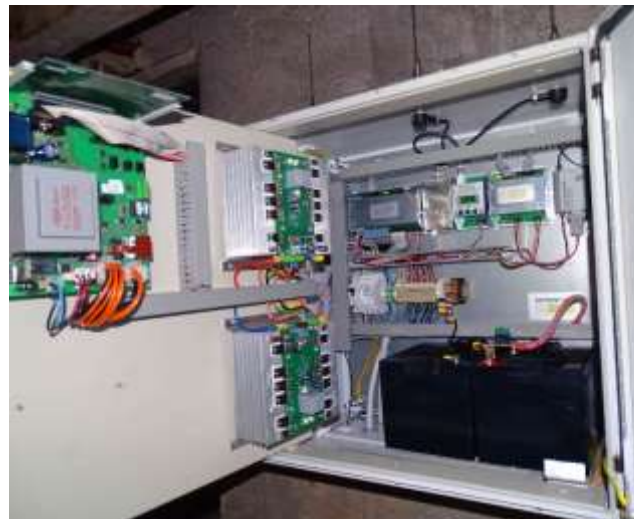
ES.16 – vnitřní vybavení ovládací skříně
