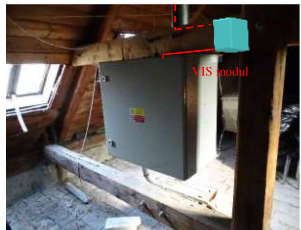
ES.18 – umístění modulu VIS, anténa bude umístěna na střeše na výložník stožáru sirény
