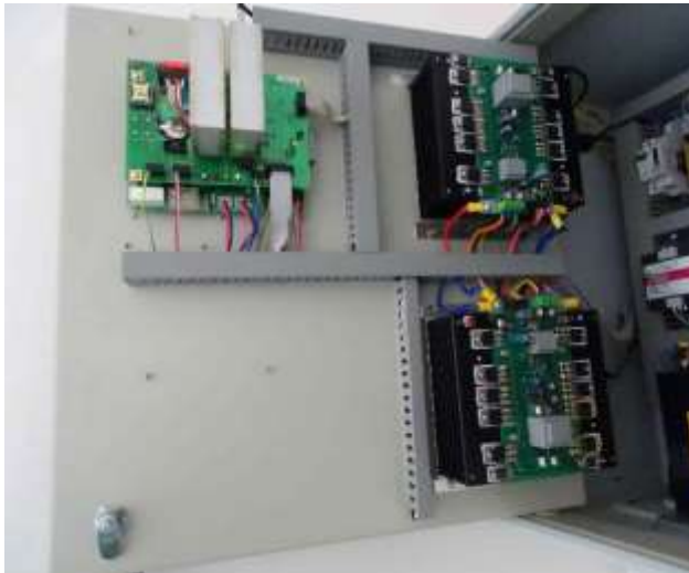
ES.14 – vnitřní vybavení ovládací skříně
