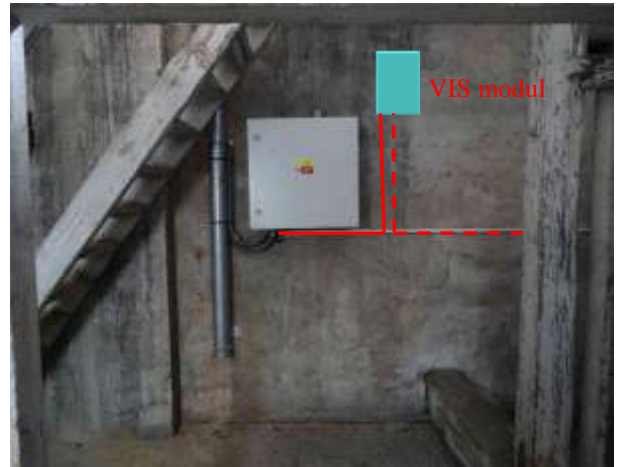
ES.13 – umístění modulu VIS, anténa bude umístěna na střeše na výložník stožáru sirény
