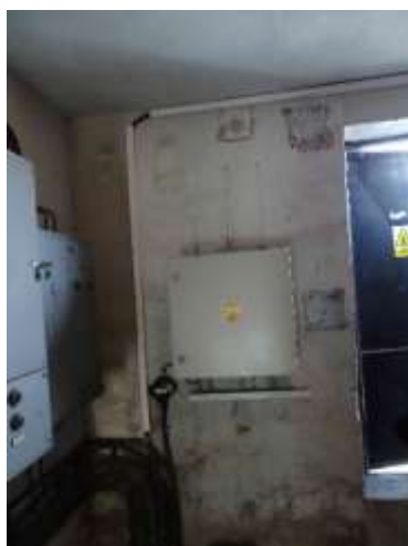
ES.11 – stávající rozvaděč sirény
