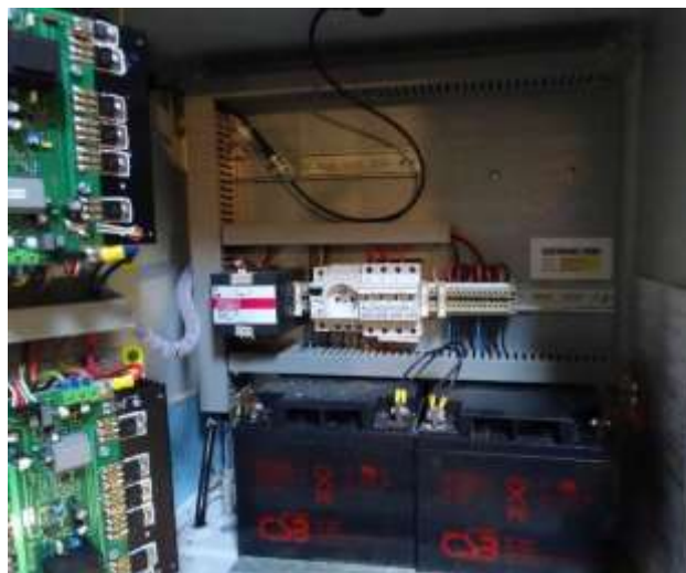
ES.20 – vnitřní vybavení ovládací skříně
