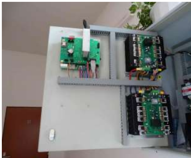
ES.3 – vnitřní vybavení ovládací skříně
