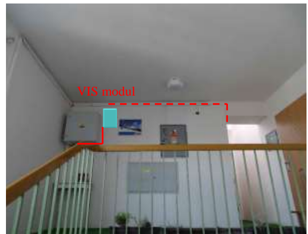
ES.14 – umístění modulu VIS, anténa bude umístěna na střeše na výložník stožáru sirény
