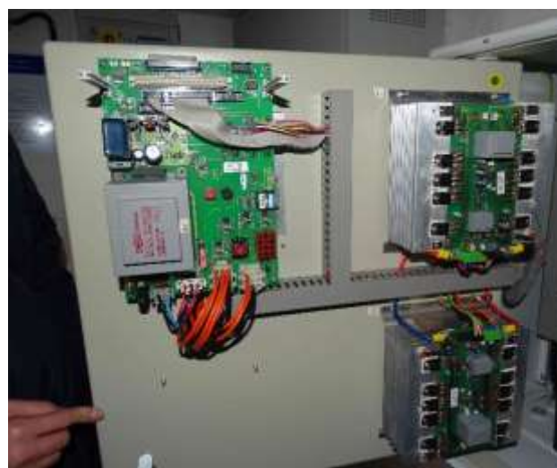
ES.1 – vnitřní vybavení ovládací skříně
