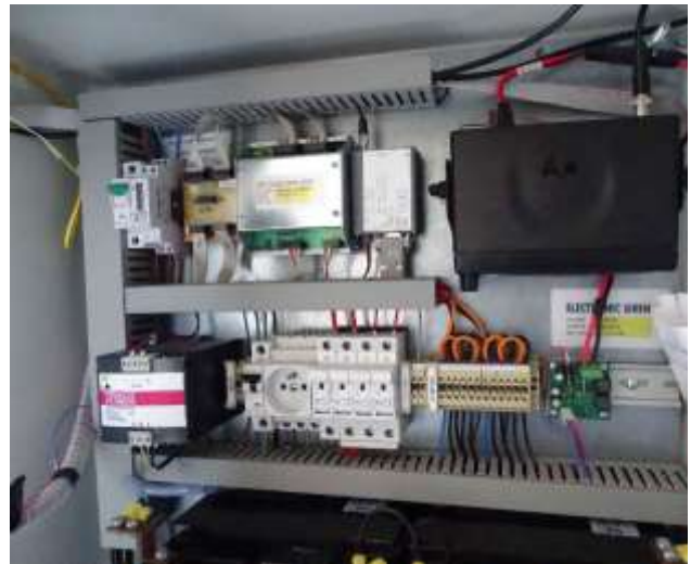
ES.10 – vnitřní vybavení ovládací skříně
