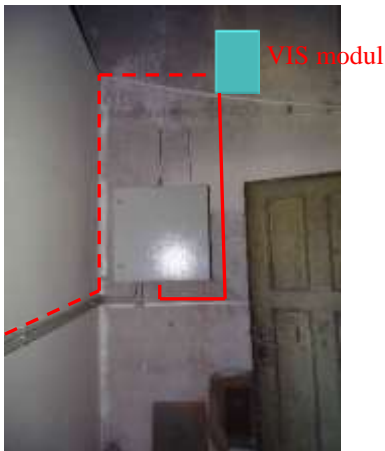
ES.17 – umístění modulu VIS, anténa bude umístěna na střeše na výložník stožáru sirény
