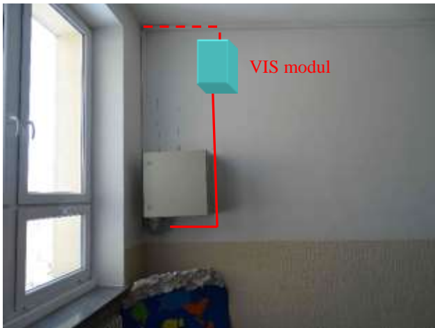
ES.12 – stávající řídicí skříň sirén na chodbě ZŠ
