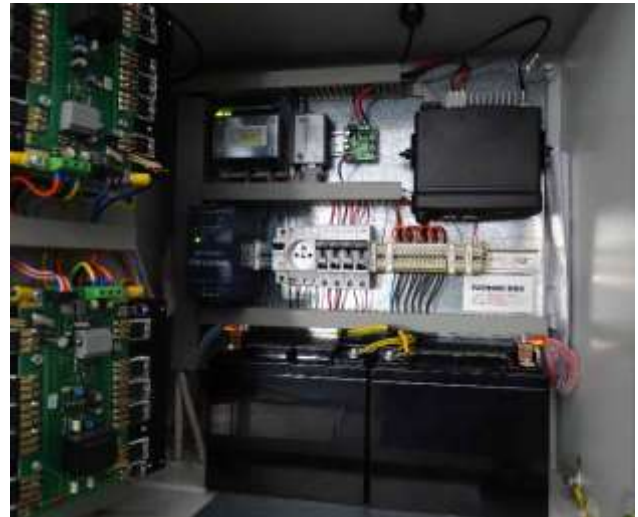
ES.13 – vnitřní vybavení ovládací skříně
