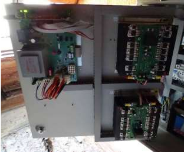
ES.18 – vnitřní vybavení ovládací skříně
