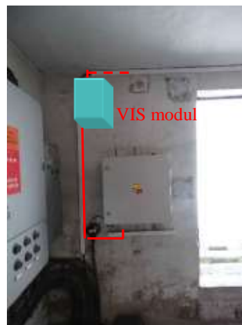
ES.11 – umístění modulu VIS, anténa bude umístěna na střeše na výložník stožáru sirény
