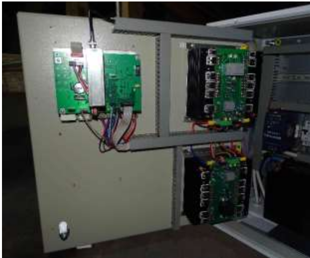
ESH.11 – vnitřní vybavení ovládací skříně
