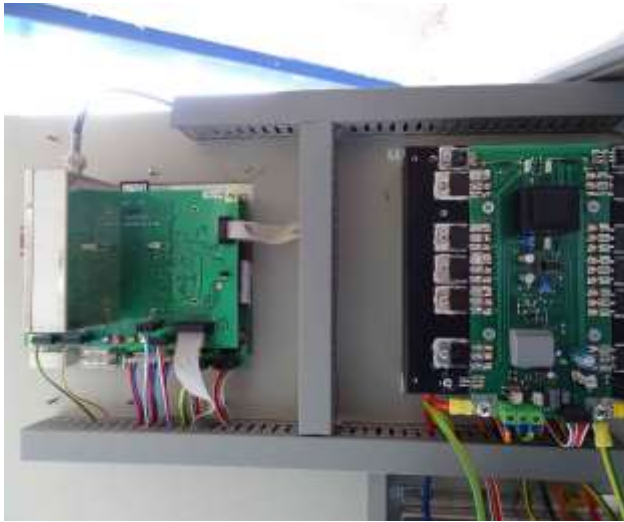
ES.10 – vnitřní vybavení ovládací skříně
