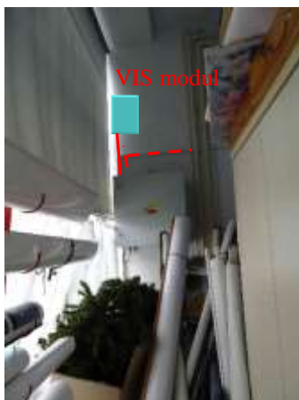
ES.22 – umístění modulu VIS, anténa bude umístěna na střeše na výložník stožáru sirény
