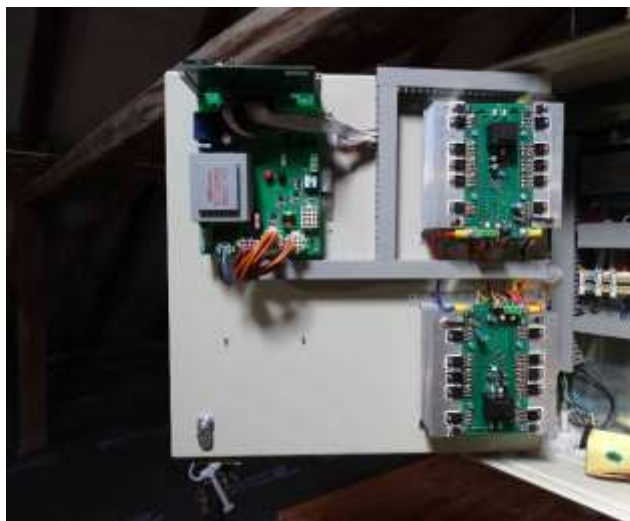
ES.19 – vnitřní vybavení ovládací skříně
