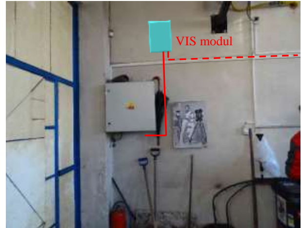
ES.5 – umístění modulu VIS, anténa bude umístěna na střeše na výložník stožáru sirény
