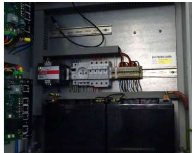
ES.5 – vnitřní vybavení ovládací skříně
