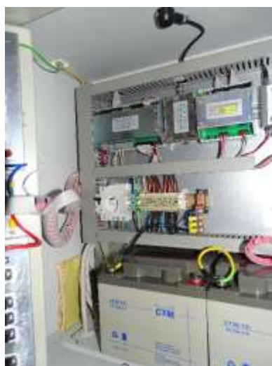
ES.15 – vnitřní vybavení ovládací skříně
