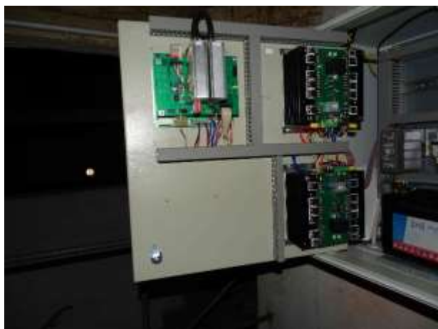
ESH.13 – vnitřní vybavení ovládací skříně
