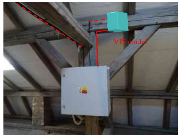
ES.9 – umístění modulu VIS, anténa bude umístěna na střeše na výložník stožáru sirény
