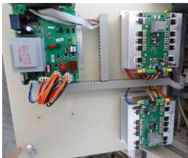
ES.11 – vnitřní vybavení ovládací skříně
