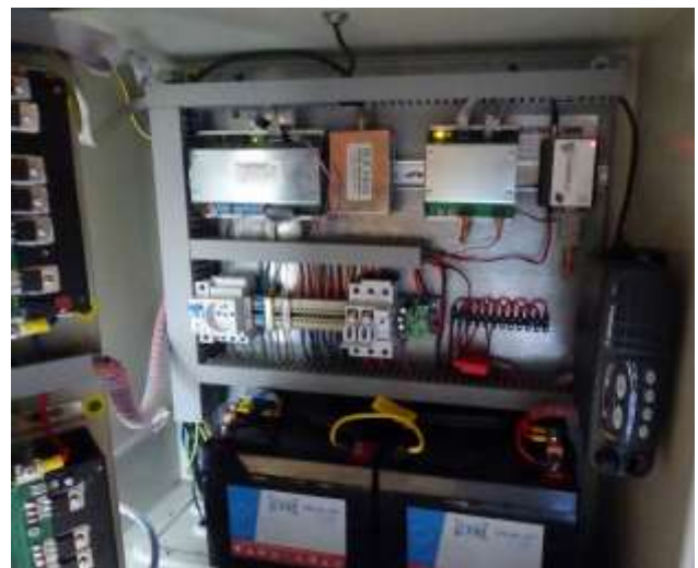
ES.18 – vnitřní vybavení ovládací skříňe
