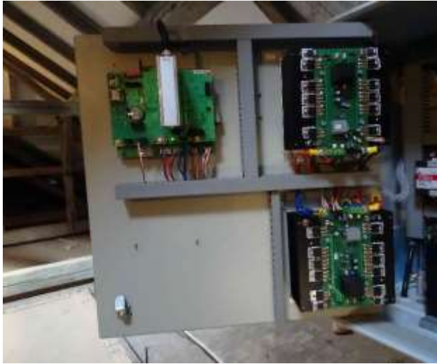
ES.20 – vnitřní vybavení ovládací skříně
