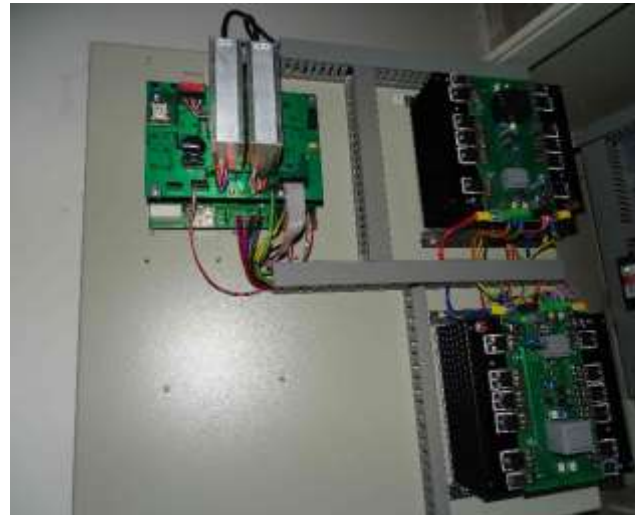
ES.17 – vnitřní vybavení ovládací skříně
