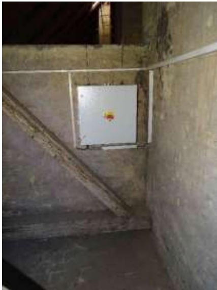
ESH.10 – stávající siréna strojovna VZT
