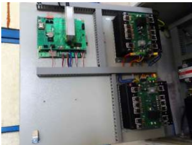
ES.5 – vnitřní vybavení ovládací skříně
