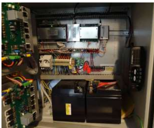
ES.11 – vnitřní vybavení ovládací skříně
