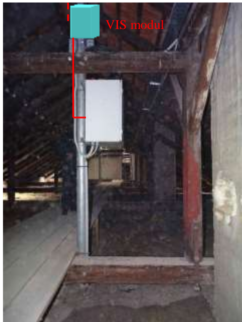
ESH.4 – stávající siréna strojovna VZT
