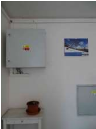
ES.14 – stávající řídicí skříň sirén na chodbě posledního podlaží obytného domu
