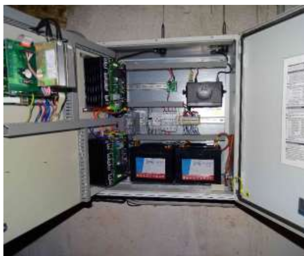
ESH.13 – vnitřní vybavení ovládací skříně
