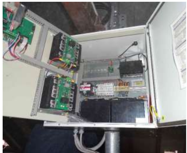
ESH.4 – vnitřní vybavení ovládací skříňe
