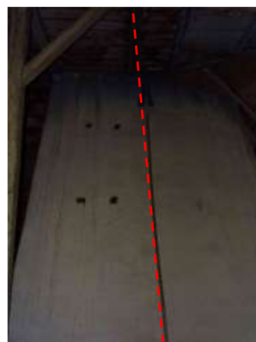
ESH.13 – anténní kabel na střechu ke stožáru sirény
