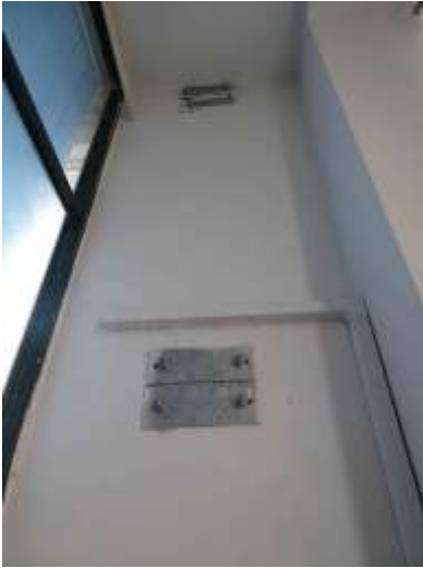
ES.22 – kotvení stožáru a stávající trasa kabelů k siréně
