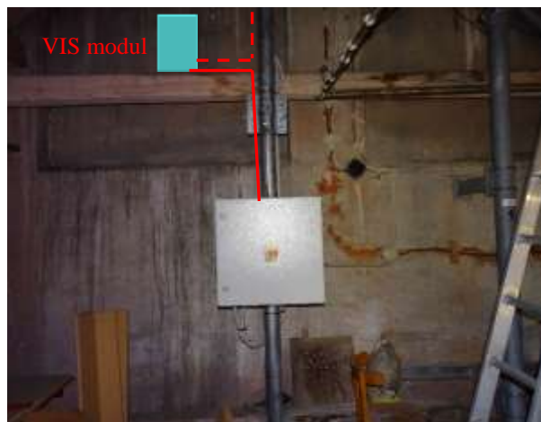
ES.15 – umístění modulu VIS, anténa bude umístěna na střeše na výložník stožáru sirény
