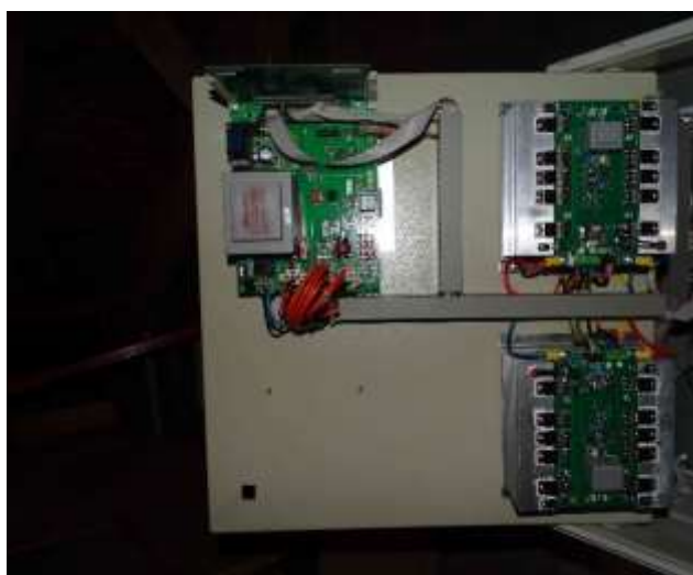
ES.15 – vnitřní vybavení ovládací skříně
