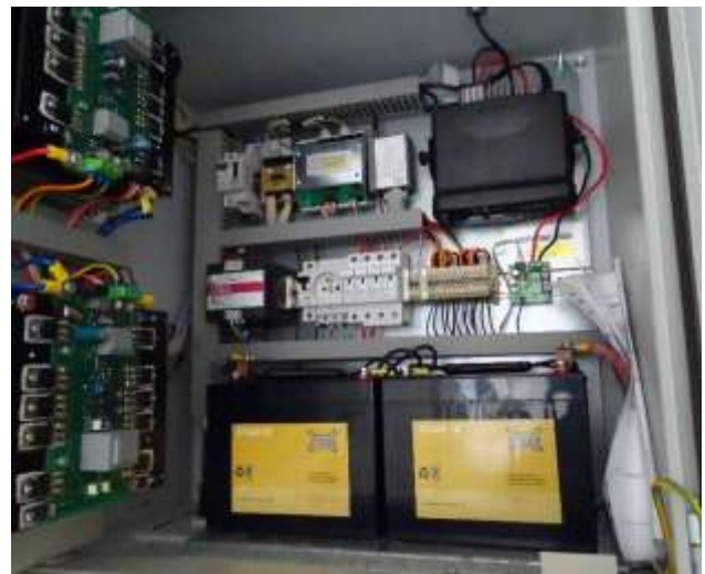
ES.14 – vnitřní vybavení ovládací skříně
