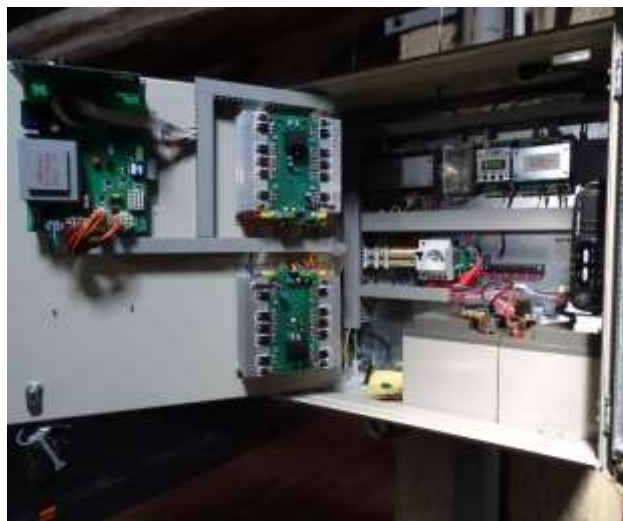
ES.19 – vnitřní vybavení ovládací skříně
