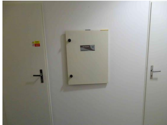
ES.25 – umístění rozvaděče stávající sirény na chodbě
