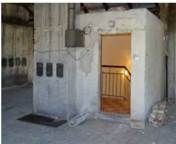
ES.24 – Nový stav, vlevo dole u vstupu je vyústění trasy z napájecího rozvaděče
