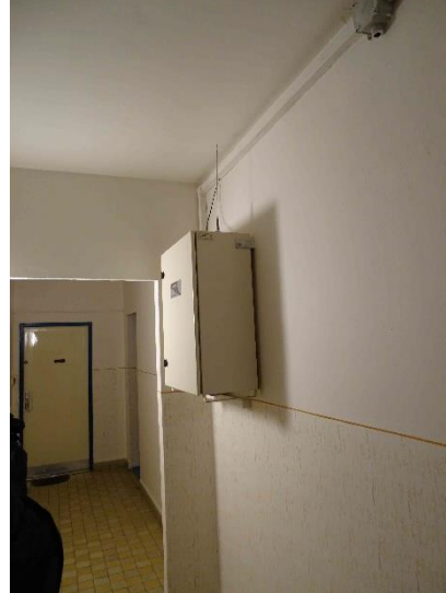
ES.21 – umístění rozvaděče stávající sirény
