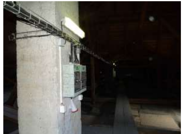
ESN.10 – umístění stávajícího rozvaděče NN v půdním prostoru
